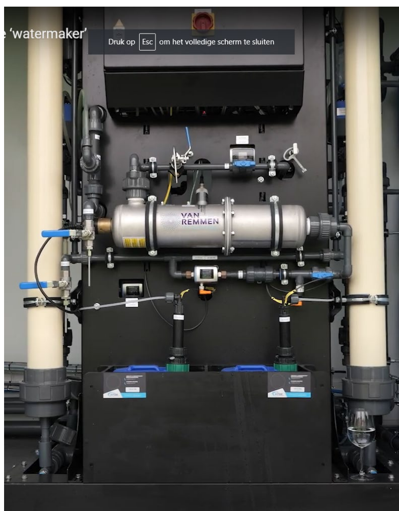
Figuur 54: UV-C installatie (Van Remmen UV Technology)
