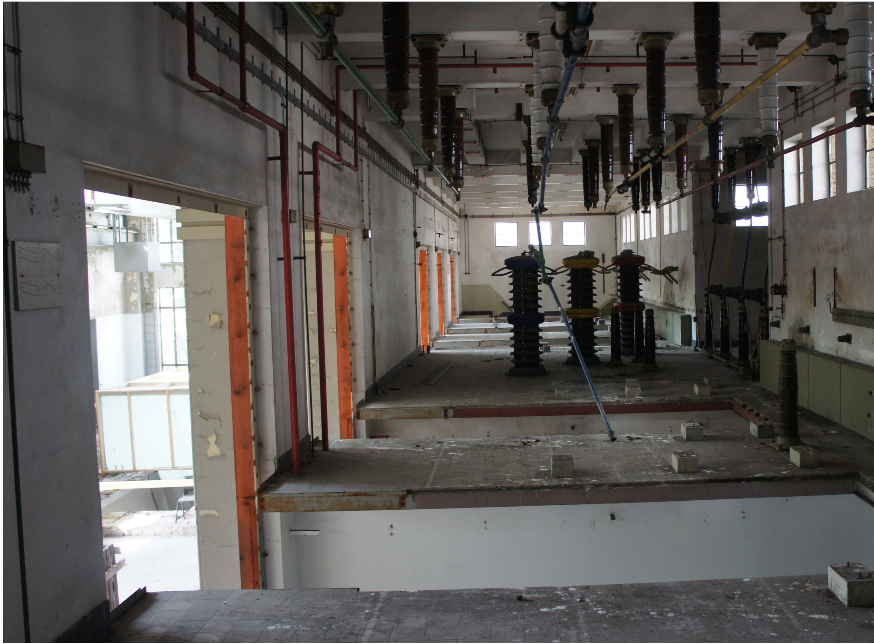
Transformator cellen bestaand
