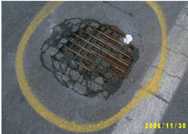
Figuur 6 Gat in het wegdek van de HSB-overlaging op de Moerdijkbrug [2]
