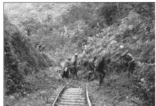
figuur 4.4: Schade ontstaan door landafschuiving in Madagaskar [54]
