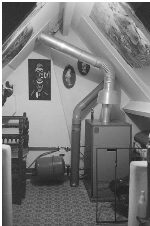
Open toestel levert een bijdrage aan de ventilatie van de woning
