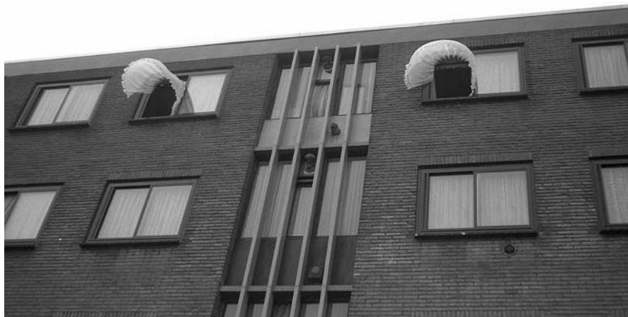
Gebruiks- problemen van ramen en roosters
