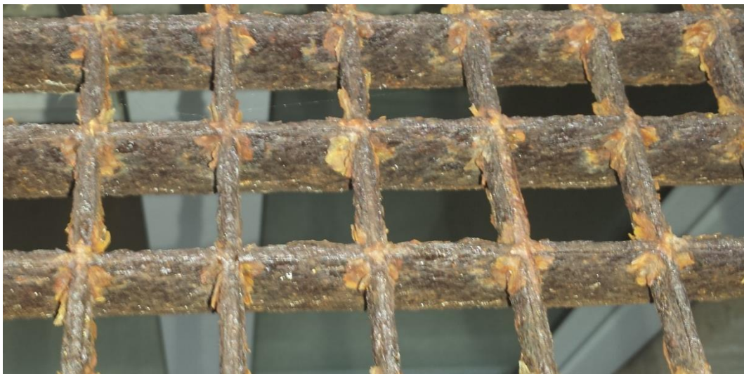
Figuur 19: Corrosie van een verzinkt persrooster na een blootstelling van 20 jaar aan de elementen
