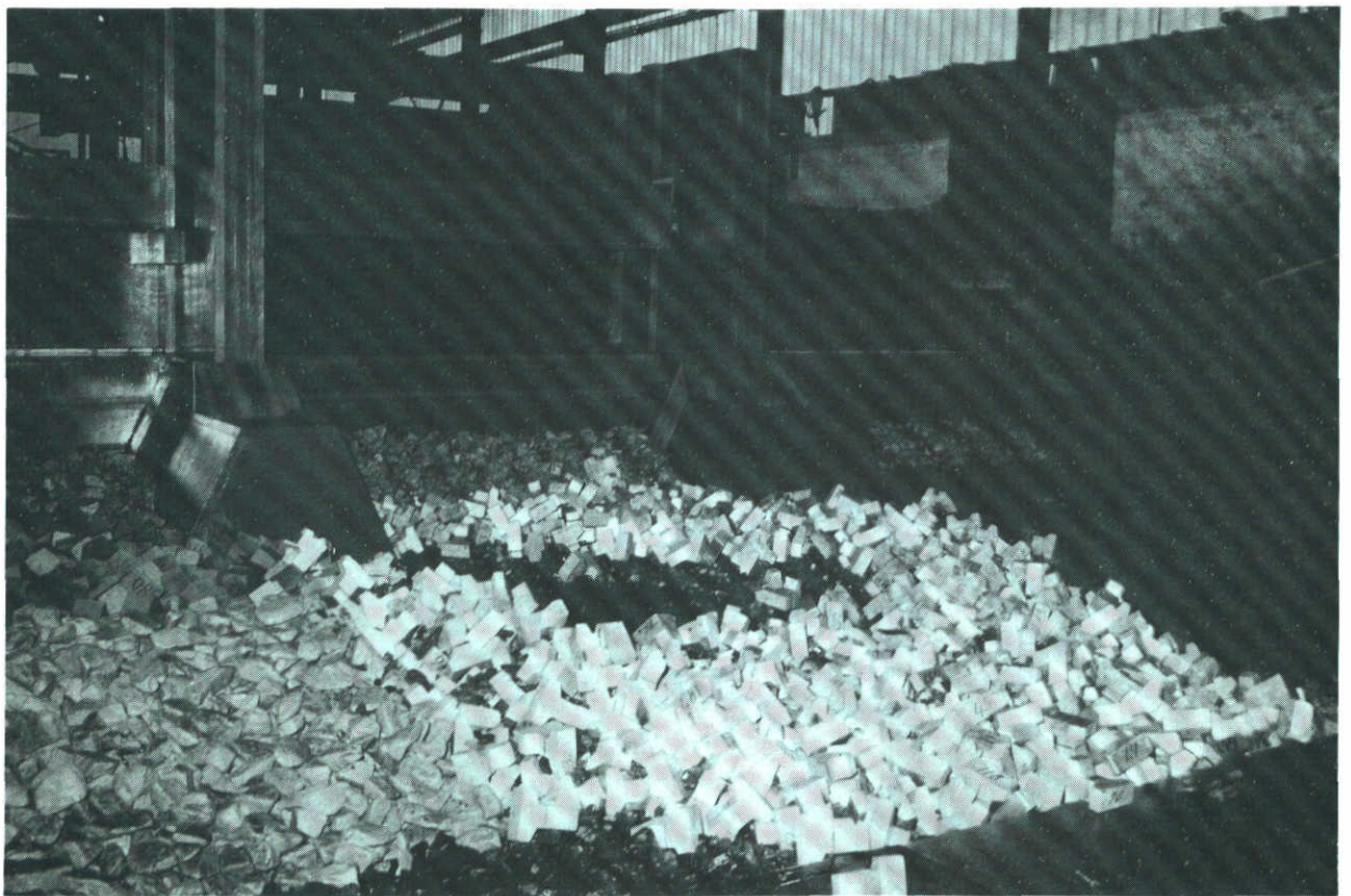
T243 Schade aan de toplaag van de drempel (akmons) tengevolge van een weigerende schuif (zie figuur 17)
