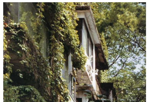
De oorspronkelijke bebouwing. Sommige panden waren uitstekend onderhouden, andere sterk verwaarloosd.
