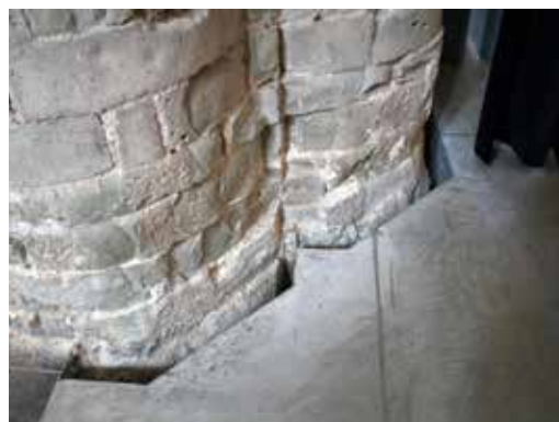
FIGUUR 3.28 Detailopname van de aansluiting van de nieuwe vloerconstructie bij één van de zuilen, 2007
