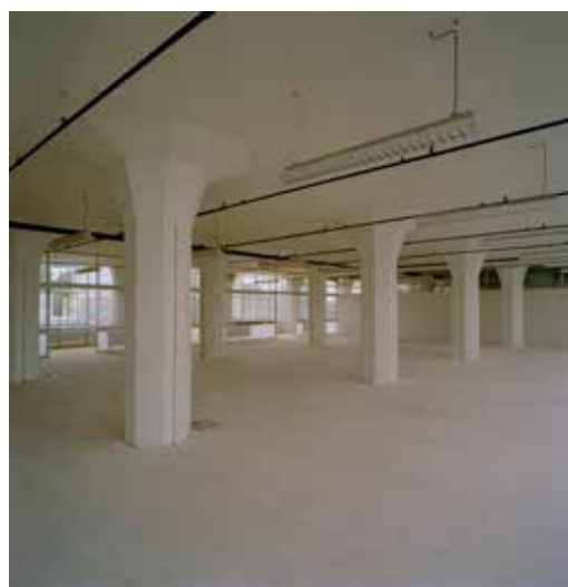
FIGUUR 6.16 Het interieur van de Van Nellefabriek werd voor het grootste deel gerestaureerd en voorzien van faciliteiten die voor de nieuwe functies nodig waren. (Interieur volledig herstel, 2001)
