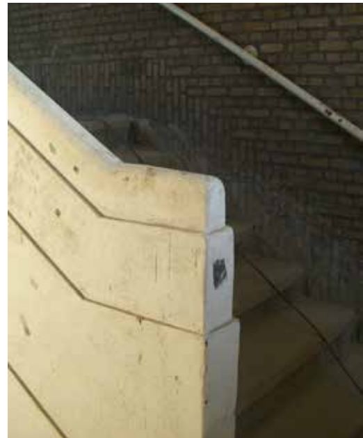
FIGUUR 5.24 In aanloop naar de restauratie bleken er nog oorspronkelijke onderdelen aanwezig, zoals deze trapbalustrade in één van de trappenhuizen, 2012
