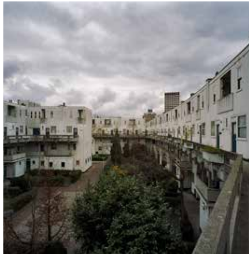
FIGUUR 5.10 In 2004 zag het complex er opnieuw vervallen uit, met name door het verweerde schilderwerk van de gevels en de slechte toestand van de kunststof plantenbakken en van de aluminium kozijnen.
