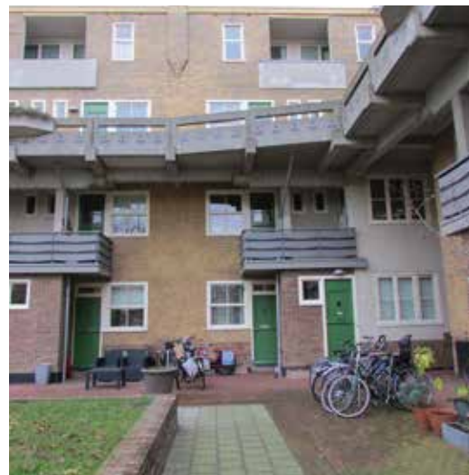
FIGUUR 5.28 Tijdens de restauratie is het metselwerk hersteld en zijn er nieuwe ramen en deuren naar oorspronkelijk ontwerp aangebracht. Ook is de verfijnde detaillering van de dakrand en de betonnen bloembakken teruggebracht, 2014
