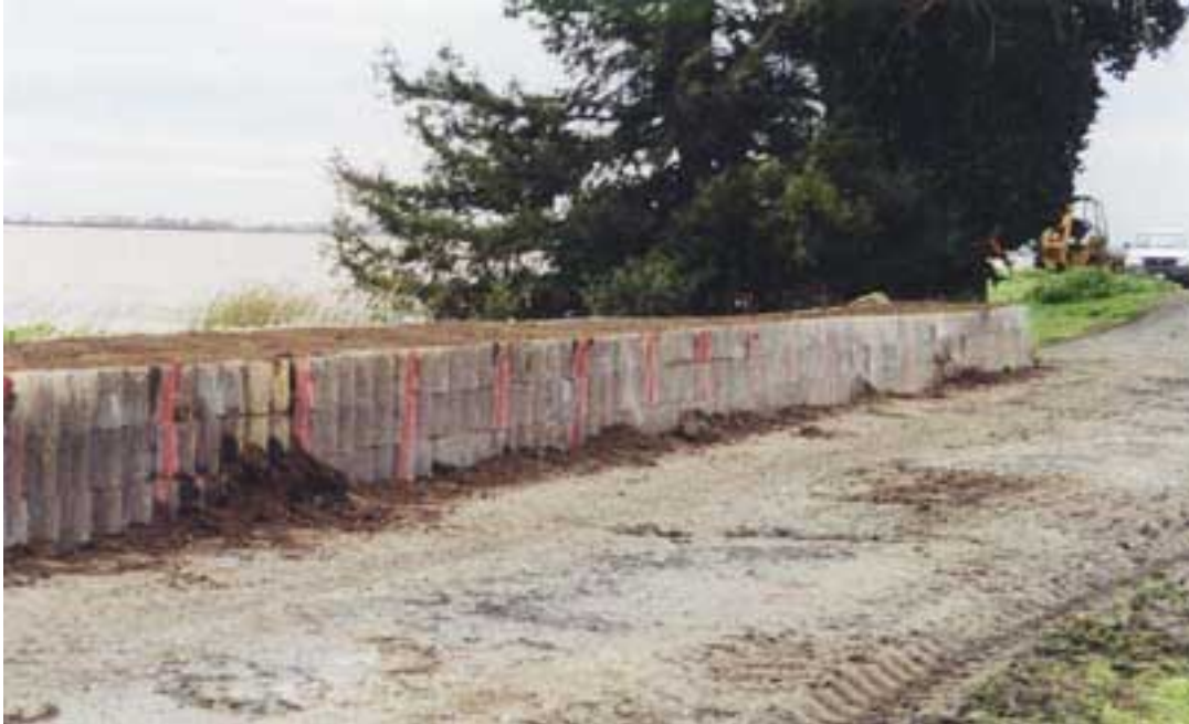
Figuur 5.8 Hier wordt de RDFW ingezet tegen golfoverslag[17].
