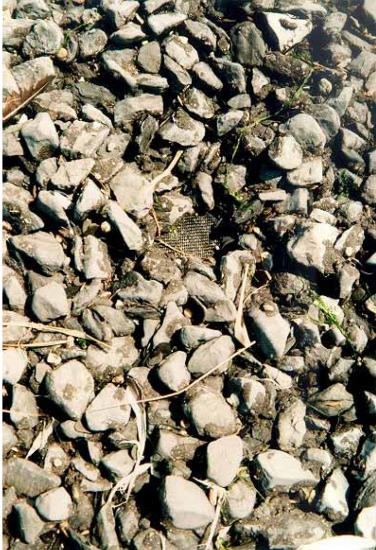
Figuur 2.7 Gat in de bekleding, onderliggende filter (geotextiel) is zichtbaar (Nieuwe Annex-Stavenissepolderdijk, Tholen, 1994)
