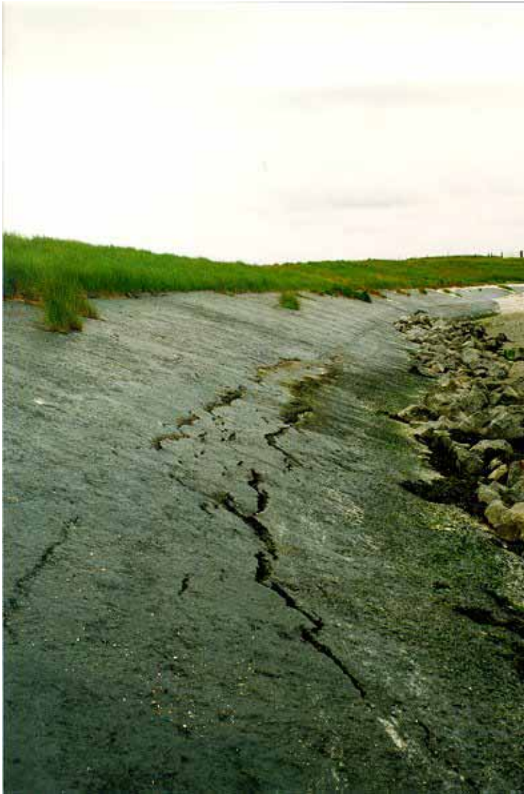
Figuur A1.4 Doorgaande scheuren op het talud (Dijk langs de Val van de Flauwersinlaag, 1996)
