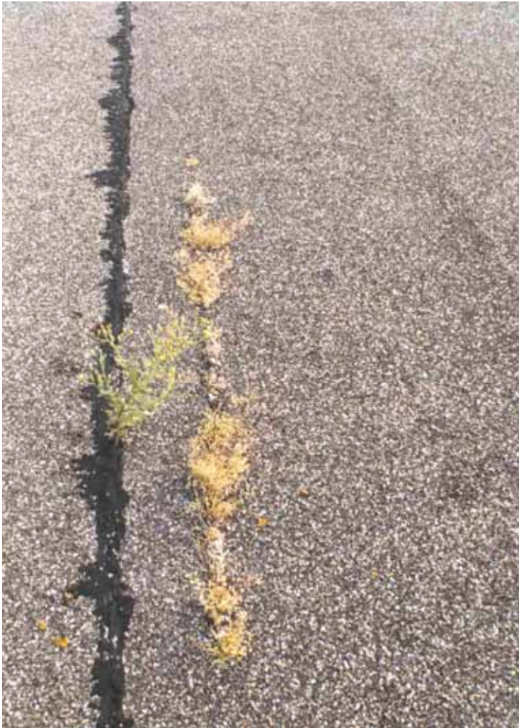
Figuur A1.16 Schade bij naad van daglas (Haringvlietdam, 2000)
