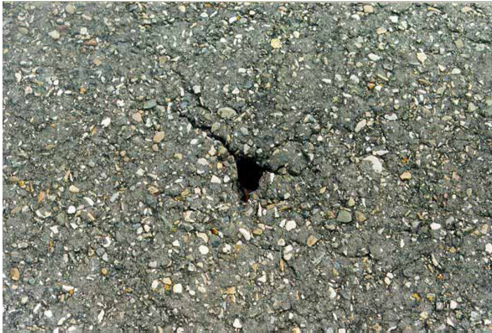
Figuur A1.23 Gat in de bekleding (Grevelingendam, 1996)
