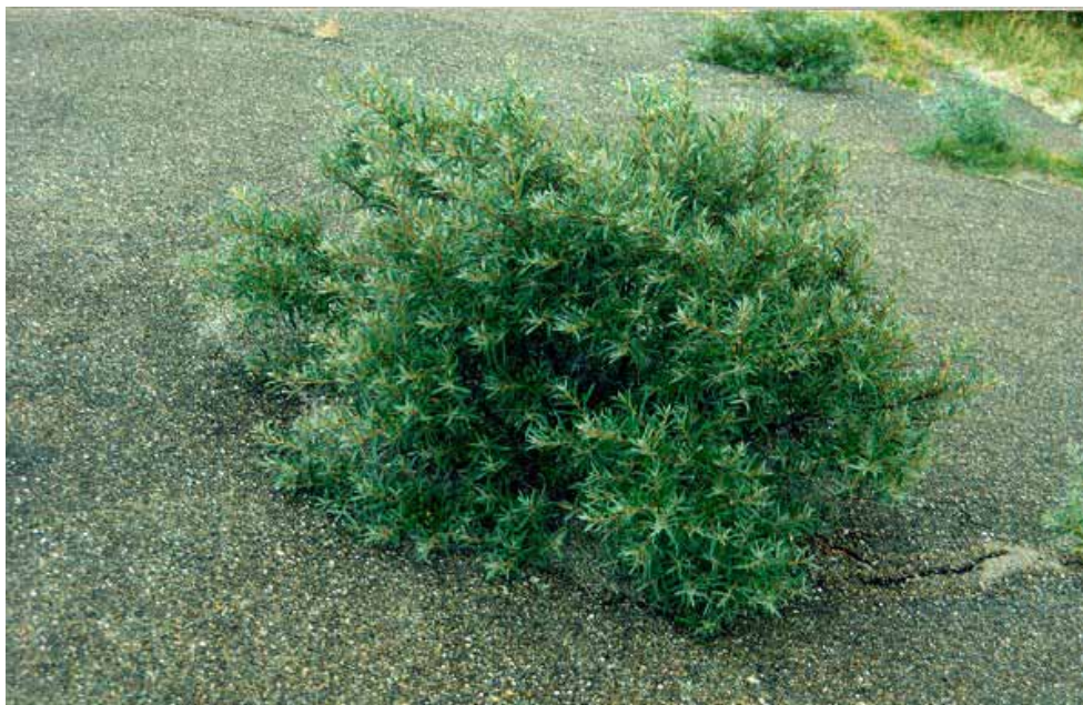
Figuur A1.6 Begroeiing in een doorgaande scheur (binnentalud Veerse dam)
