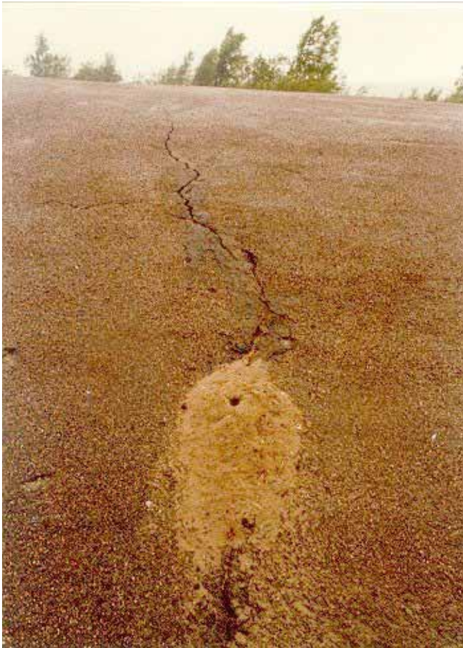
Figuur A1.7 Uitspoeling van grond uit een doorgaande scheur (glooiing op Hellegatplaten, 1981)
