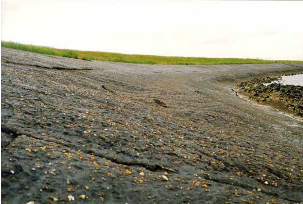
Figuur A1.12 Kuil in het talud ten gevolge van onregelmatige zettingen en de neiging van de grond om af te schuiven (Dijk langs de Val van het Flauwersinlaag, 1996)
