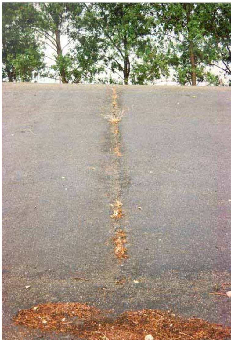
Figuur A1.14 Verticale openstaande naad (Dijk langs de Van Pallandtpolder, 1989)
