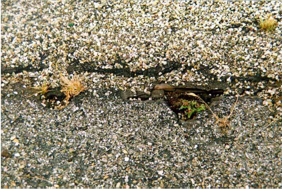
Figuur A3.2 Aangetaste overgang bij waterbouwasfaltbeton (Dijk nabij Stad aan 't Haringvliet, 1996)
