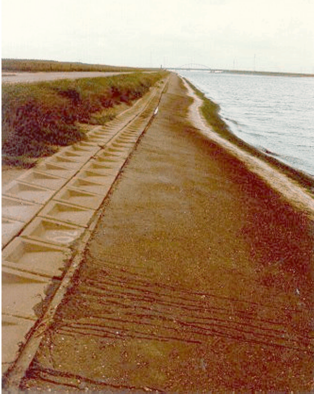
Figuur A1.11 Zettingskuil in het talud (Schelde-Rijnkanaal, 1981)
