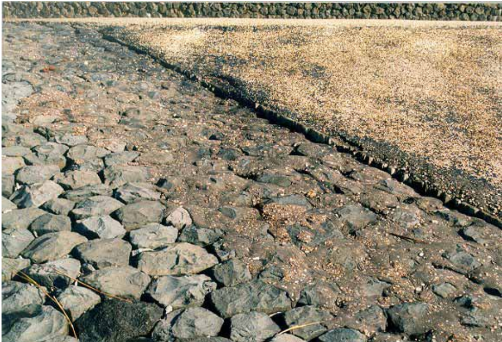
Figuur A3.8 Verzakking ter plaatse van een overgangsconstructie (Vlissingen, 1996)
