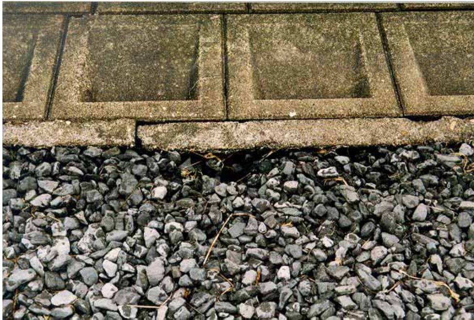
Figuur A3.4 Aangetaste overgang bij open steenasfalt (Krabbebeek, 1996)
