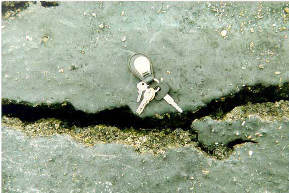
Figuur A1.5 Detail van de scheur (Dijk langs de Val van de Flauwersinlaag, 1996)
