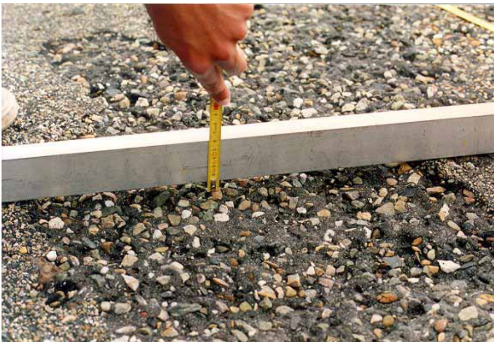
Figuur A1.22 Aangetast oppervlak, detail meer dan 1 steenlaag verdwenen (Vlissingen, 1993)
