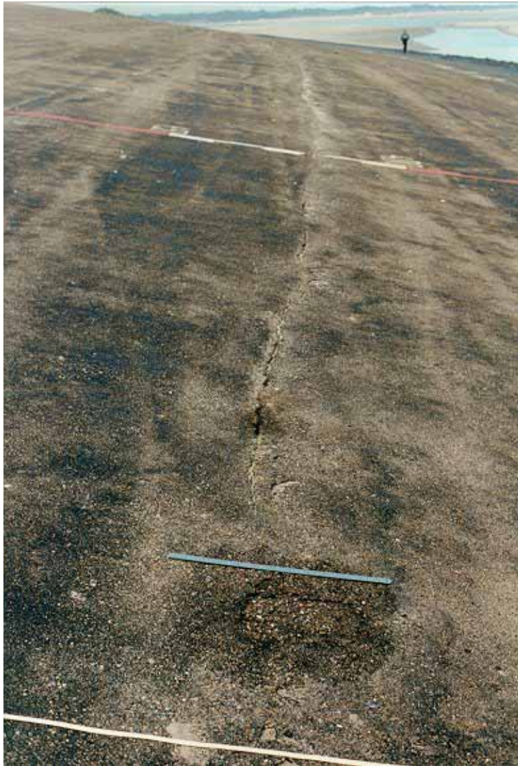
Figuur A1.15 Horizontale openstaande naad (buitentalud Veerse dam, 1989)
