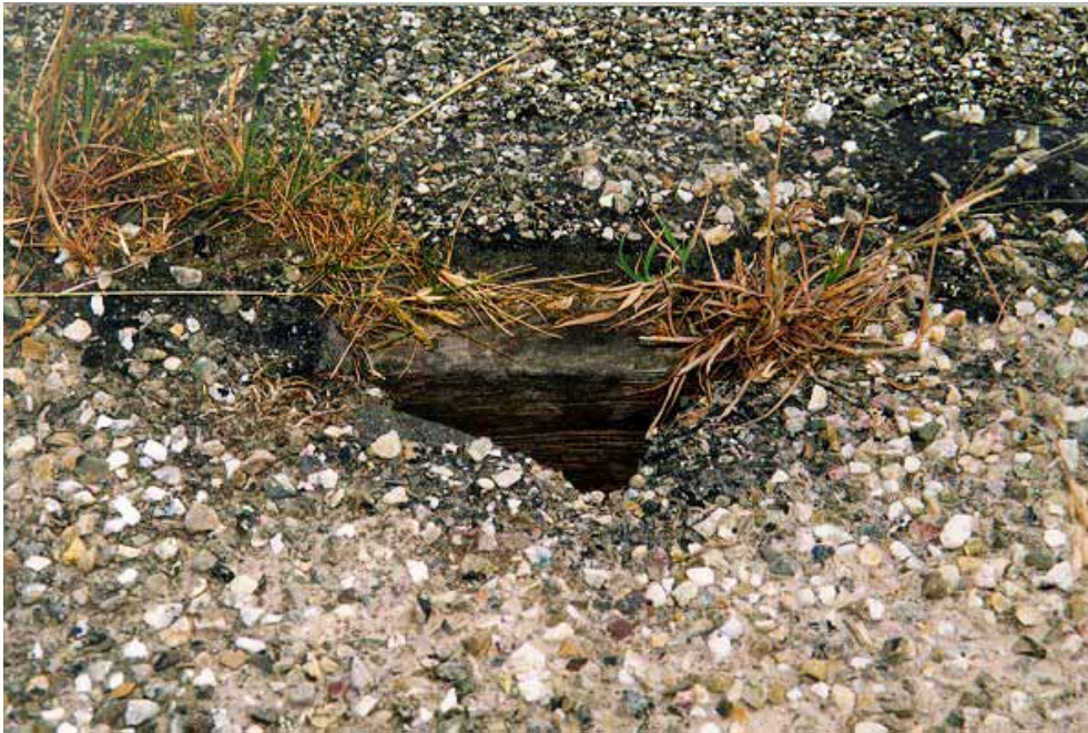
Figuur A3.3 Afgebrokkelde rand t.p.v. de overgang bij waterbouwasfaltbeton (Dijk nabij Stad aan 't Haringvliet, 1996)
