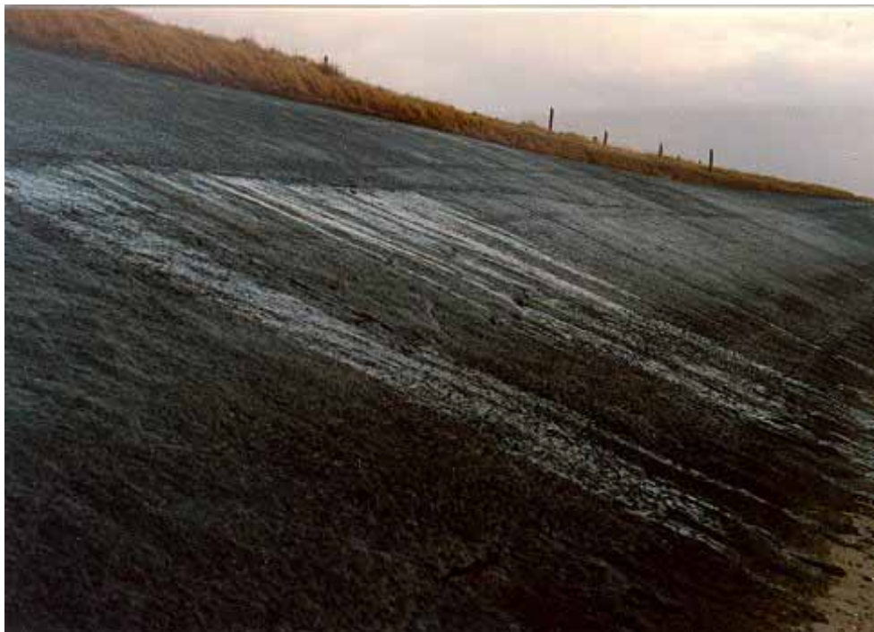
Figuur A1.19 Water stroomt uit openstaande naad (Schelphoek, 1986)
