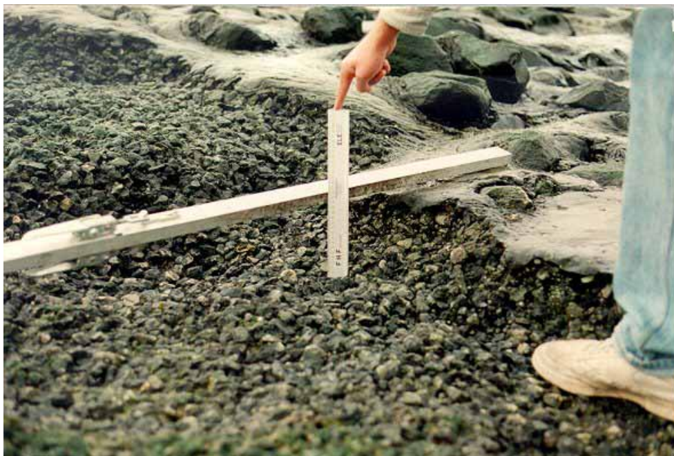
Figuur A3.5 Aangetaste overgang bij open steenasfalt (Noordland, 1994)
