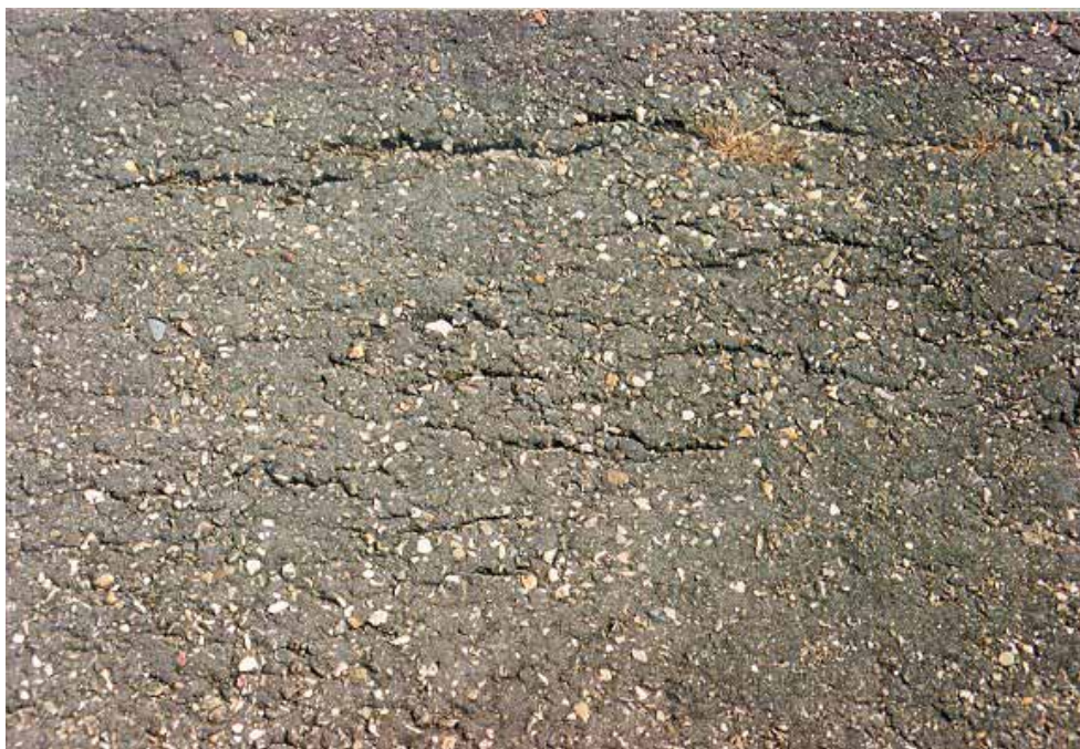
Figuur A1.9 Niet doorgaande scheuren (Grevelingendam, 1996)
