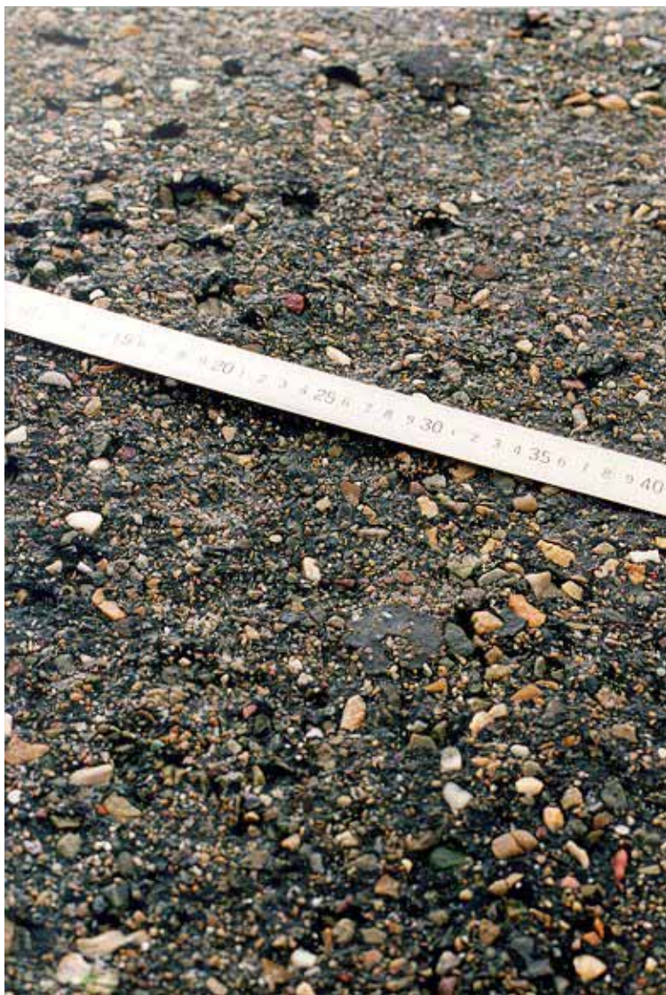
Figuur A1.20 Aangetast oppervlak enkele steentjes verdwenen (Vlissingen, 1993)
