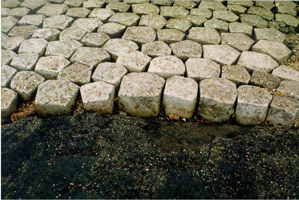
Figuur A3.7 Openstaande en ingezakte overgang (Dijk langs de Val van het Flauwersinlaag, 1996)
