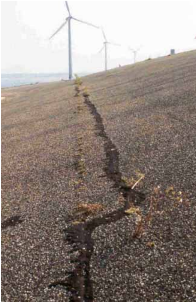
Figuur A1.17 Schade bij naad van daglas (Haringvlietdam, 2000)
