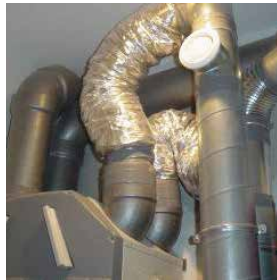
Afbeelding 2 (Installatie voor balansventilatie)
