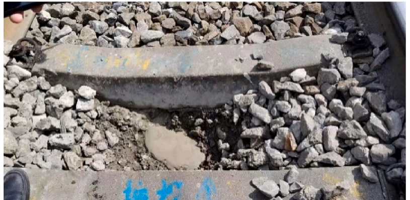
Fig. 18. Ballast layer fouling.
