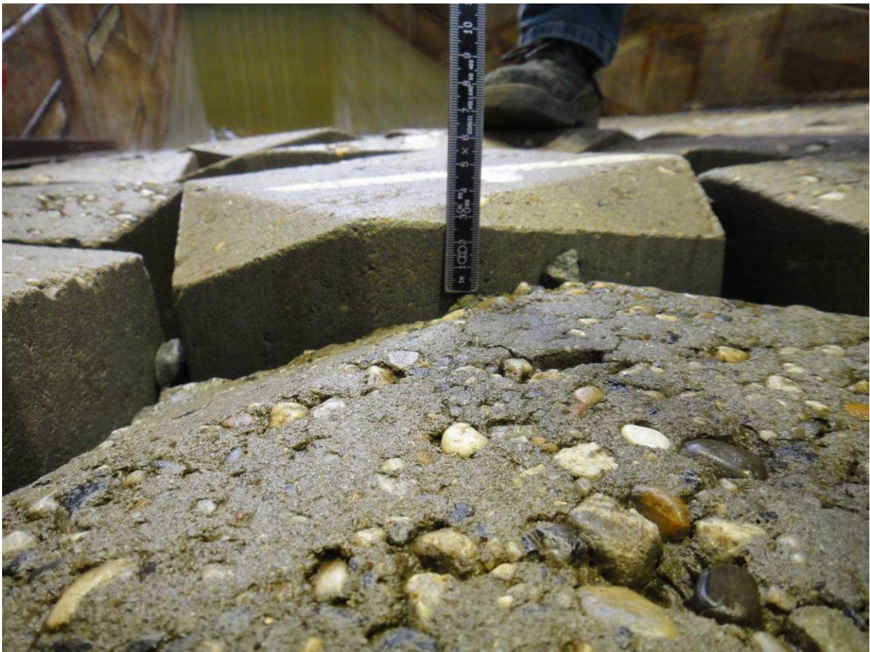
b) Schade na proef 8 (3)
