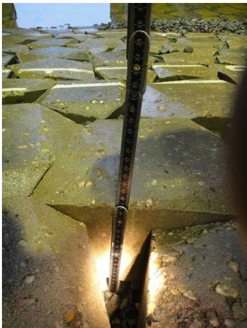
b) Schade na proef 3
