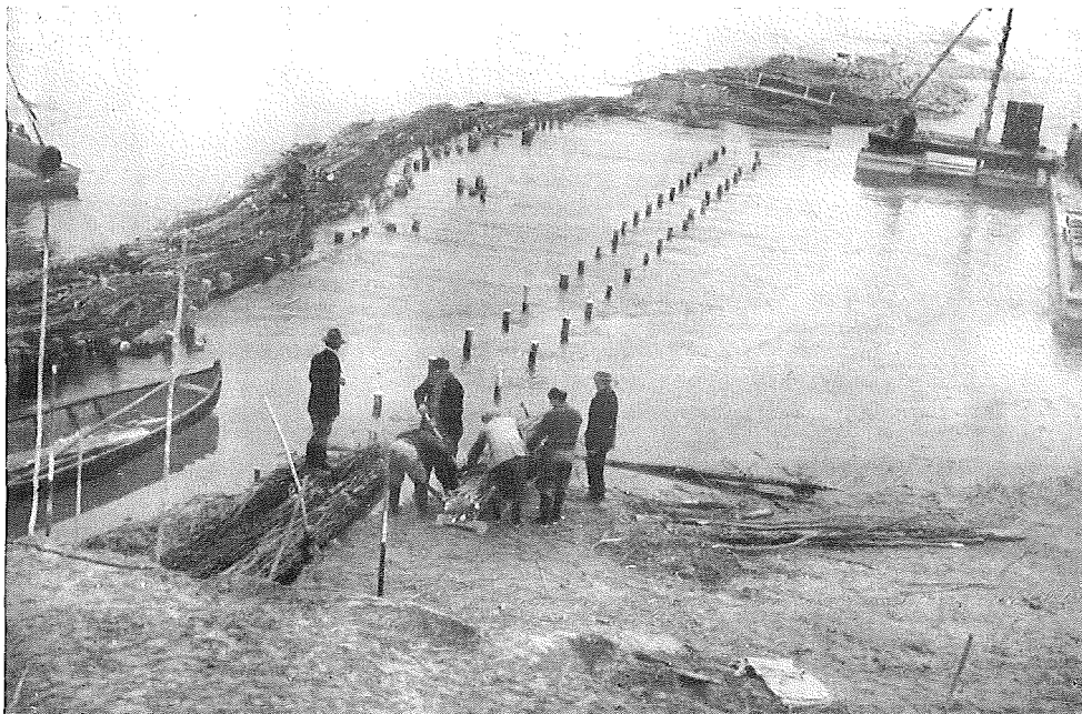
Fig. 20 SITUAZIONE IN CORSO DI LAVORO PER LA RIPRESA DELLA ROTTA ALLA CURVA N. 46 DI OLZA
