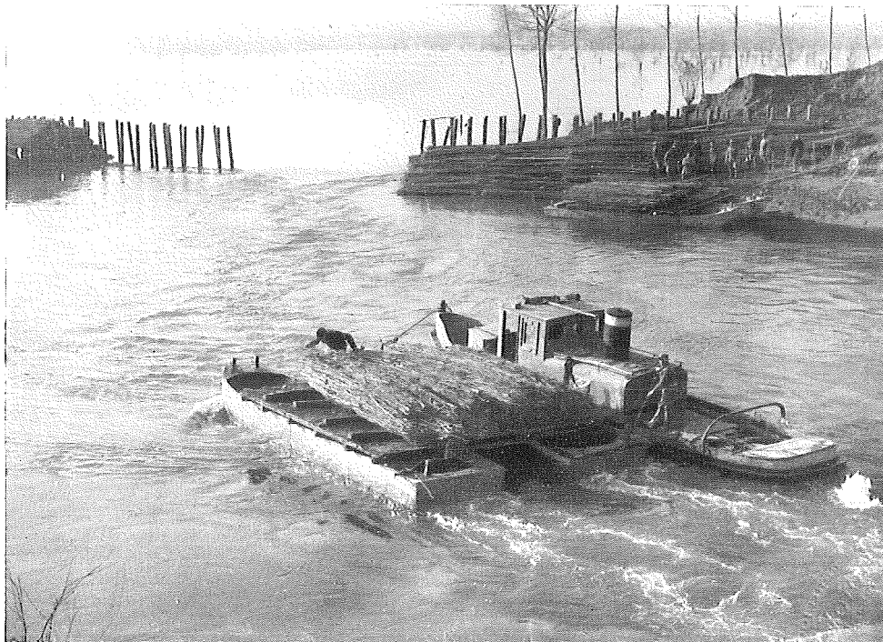
Fig. 22 INIZIO DEI LAVORI DI CHIUSURA ALLA ROTTA PRODotta, PER RIGURGITO DEL PO, DALLA PIENA DEL 1951, SULL'ARGINE SINISTRO DEL CROSTOLO PRESSO GUALTIERI EMILIA
