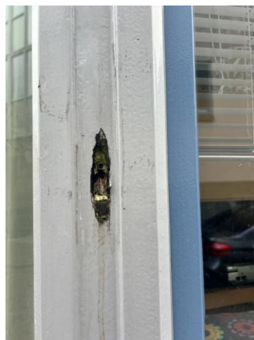
31: Beschadiging aan een houten kozijn, wat houtrot kan veroorzaken. Eigen afbeelding, 2025.
