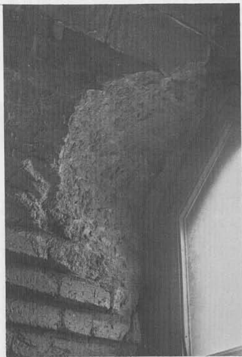
De binnenzijde van een raam, waarvoor een deel van de console is weggehakt.
