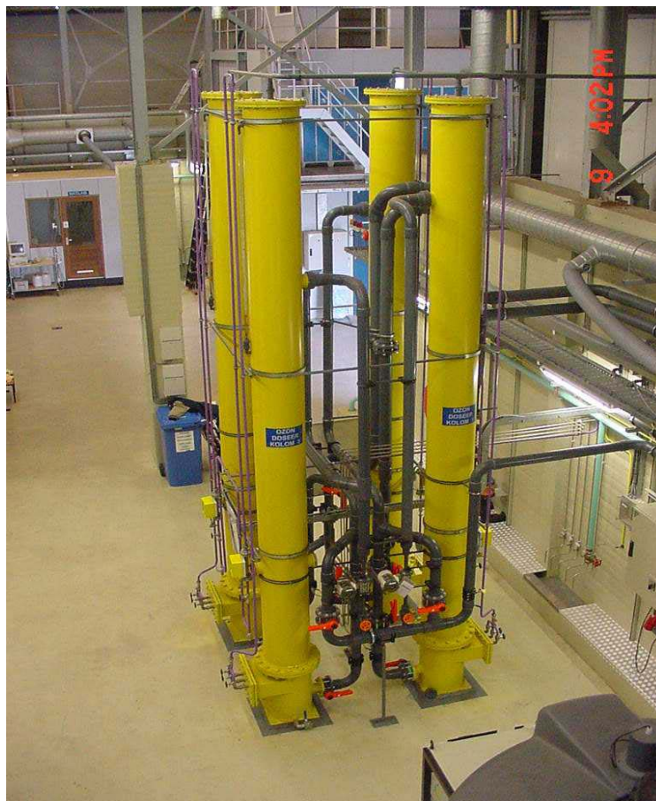
Figuur 5.2: De 4 gele ozondoseerkolommen in de proefinstallatie.
