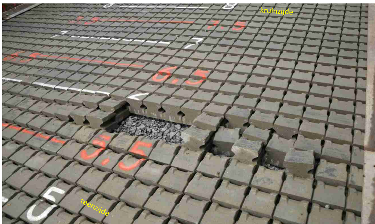
a) na het verwijderen van de losliggende zuilen uit het gat, was duidelijk zichtbaar dat de steenzetting kruinwaarts van de rug tot enkele centimeters boven de filterlaag zweefde (proef R02, serie 1)
