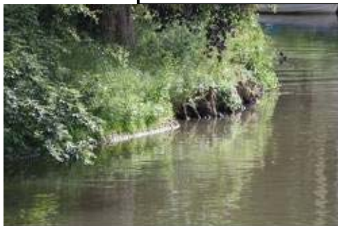
Foto: oever met metselwerk in verval
