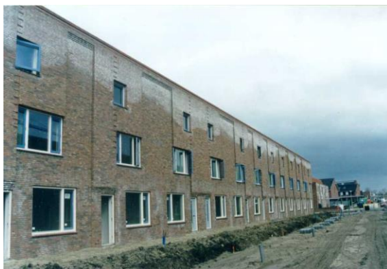
Fig. 4. Vroege sulfaatuitbloei op metselwerk vlak na uitvoering.
