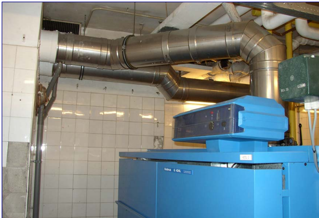
Figuur 0-1 CV-ketel in de kelder
