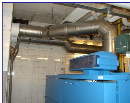
Figuur 5-14 CV-ruimte in de kelder
