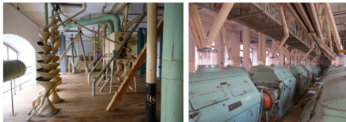
Image 56-57: Machinery inside the Milling (left: Hielkje Zijlstra)
