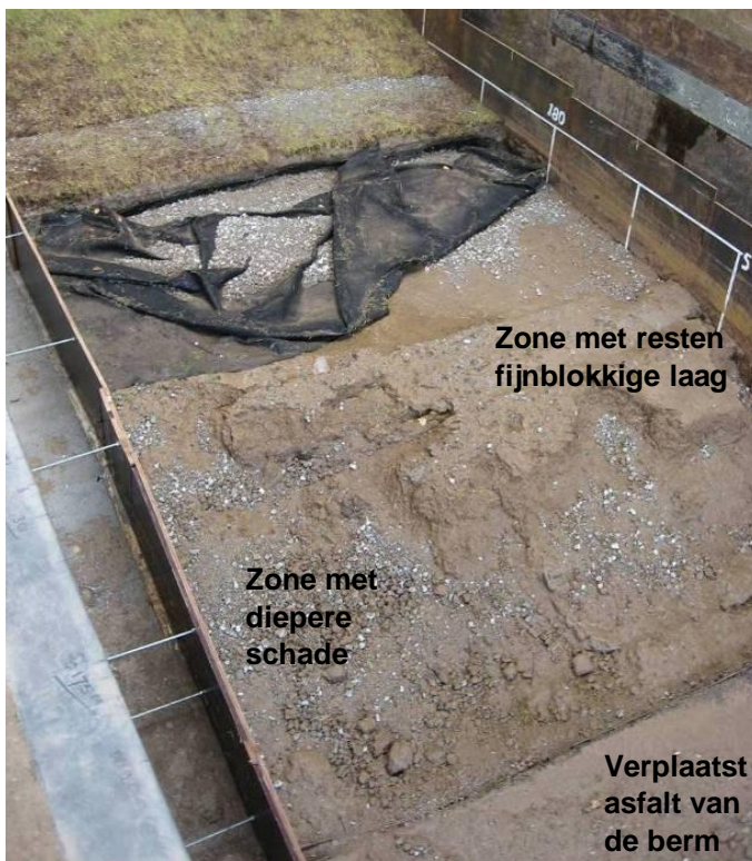
Figuur 6.13 De schade is over grote delen van het talud dieper dan de fijnblokkige laag geworden na bijna 0,52 uur belasten.
