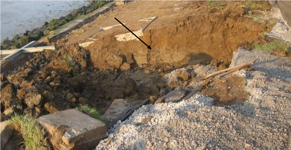
Figuur 6.7 De klei onder de gezette steen in de dijk bij Oosterlande. De bovenlaag ligt ter plaatse op een horizontale overgang met de erondergelegen zandiger klei (overgang van bruin rossig naar licht bruingrijs, zie pijl).
