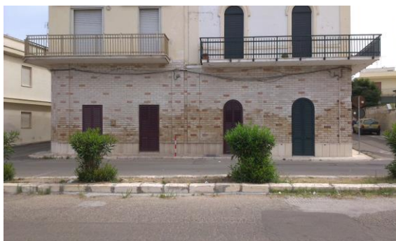
Fig. 1. Optrekkend vocht in de muur van een gebouw.
