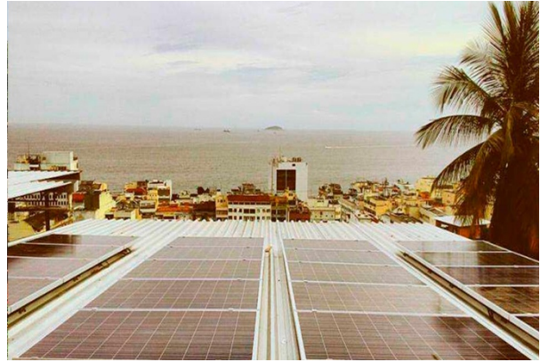
Figure 1-14 “ Escolinha Tia Percília ” PV power plant (2019).
