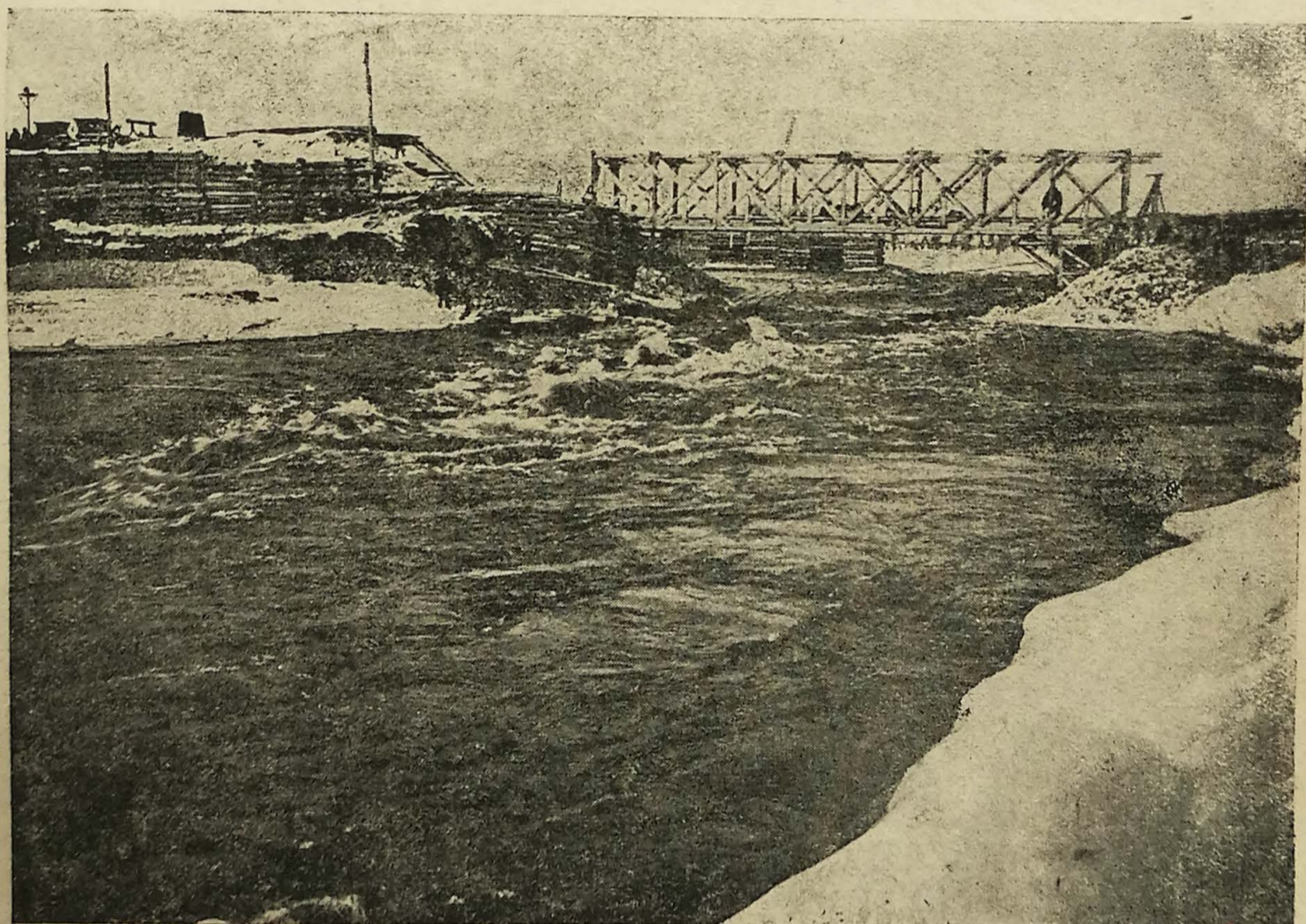
Фиг. 19. Вид со стороны нижнего бьефа на низовой откос наброски — быстротока (Нива II).
