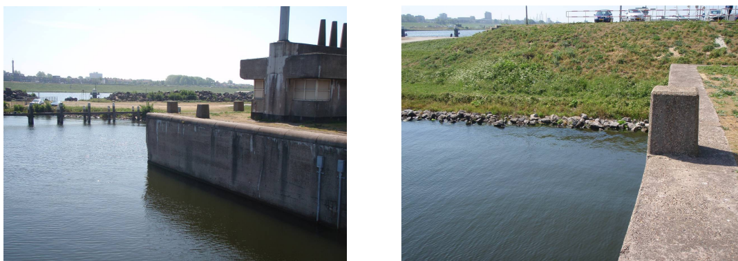
Figuur 29: Zuidelijke oeverbescherming Noordzeekanaalzijde; gezien van voor de sluis (links) en van dichtbij (rechts)
