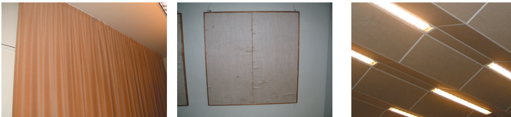
Figuur 4.22. Verschillende absorptiematerialen in het Conservatorium van Amsterdam.
