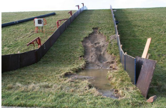
Figuur 3.1. Boonweg. Sectie 3. Na de proef, schade aan het talud en aan de teen.
