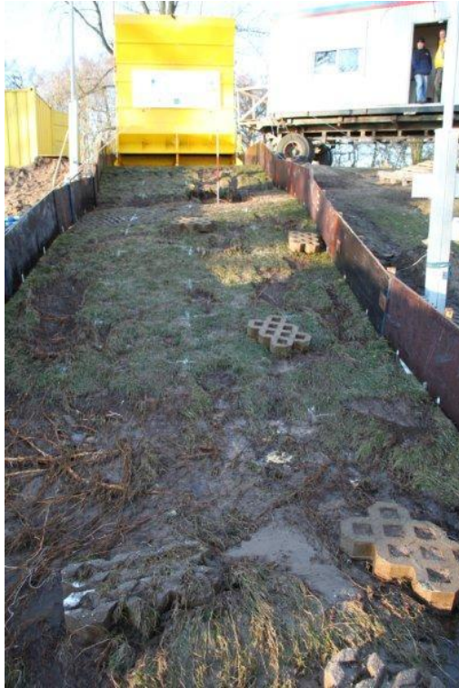
Figuur 4.4. Vechtdijk. Zeeregime met dijkovergang, proef 1; Talud na de proef niet bezweken.
