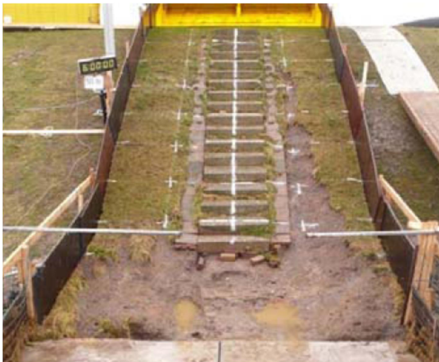
Figuur 4.3. Afsluitdijk. Sectie 3. Meerdere/grotere kale plekken op het talud.
