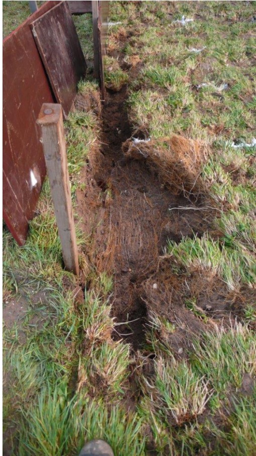
Figuur 4.10. Nijmegen, sectie 1. Bezwijken grastalud langs en onder de geleiding.
