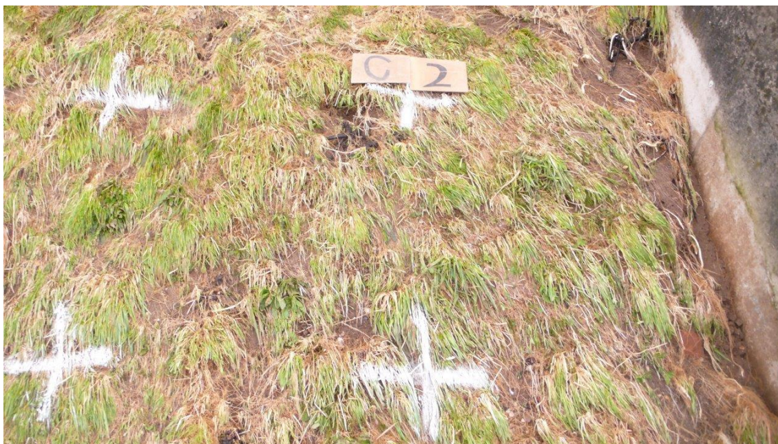
Figuur 4.11. Nijmegen, sectie 1. Begin schade langs betonnen rand.
