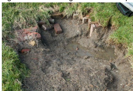
Figuur 3.2b. Boonweg. Sectie 2. Na de proef, geen schade aan het talud wel aan de teen.
