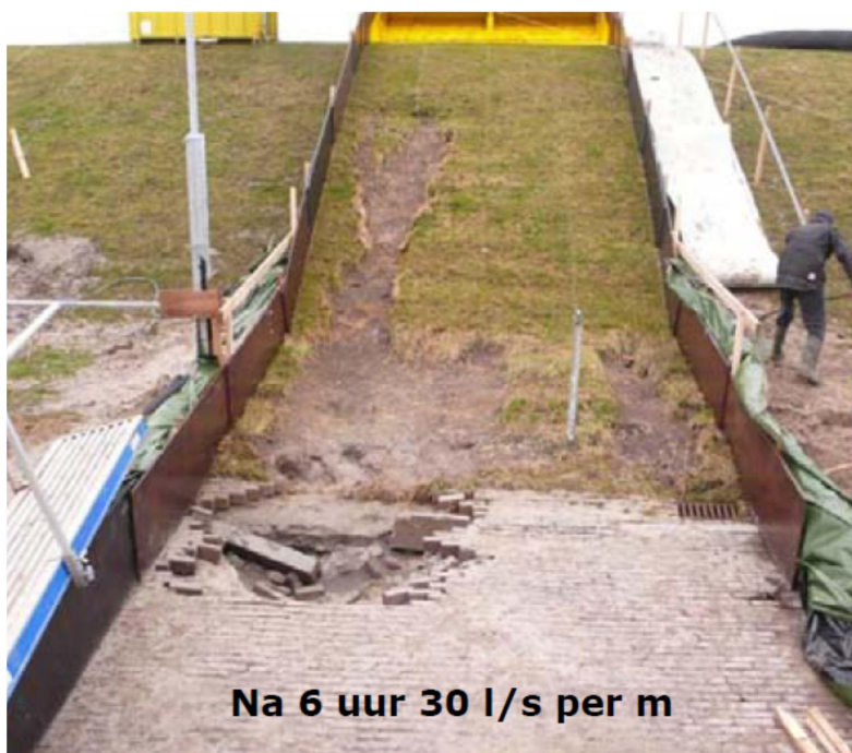
Figuur 4.2. Afsluitdijk. Sectie 2. Bezwijken van de klinkerbestrating op zand.
