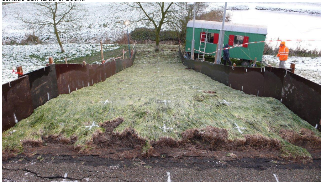
Figuur 4.6b. Tielrode, België. Durmedijk. Na alle series. Geringe uitbreiding schade overgang asfaltkruin naar gras. Geen schade aan talud of boom.
