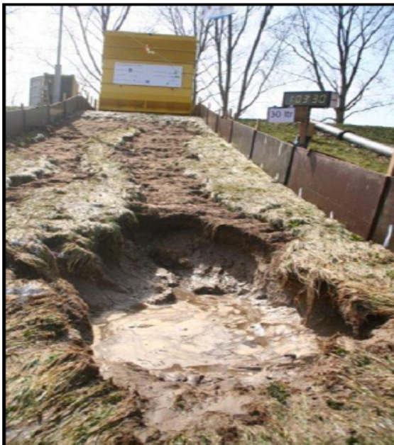
Falen van de dijk (zandkern is zichtbaar)
