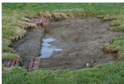
Figuur 3.2a. Boonweg. Sectie 1. Na de proef, geen schade aan het talud wel aan de teen
