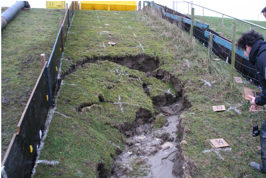
Figuur 4.9. Tholen. Sectie 3, afrastering. Bezweken talud.
