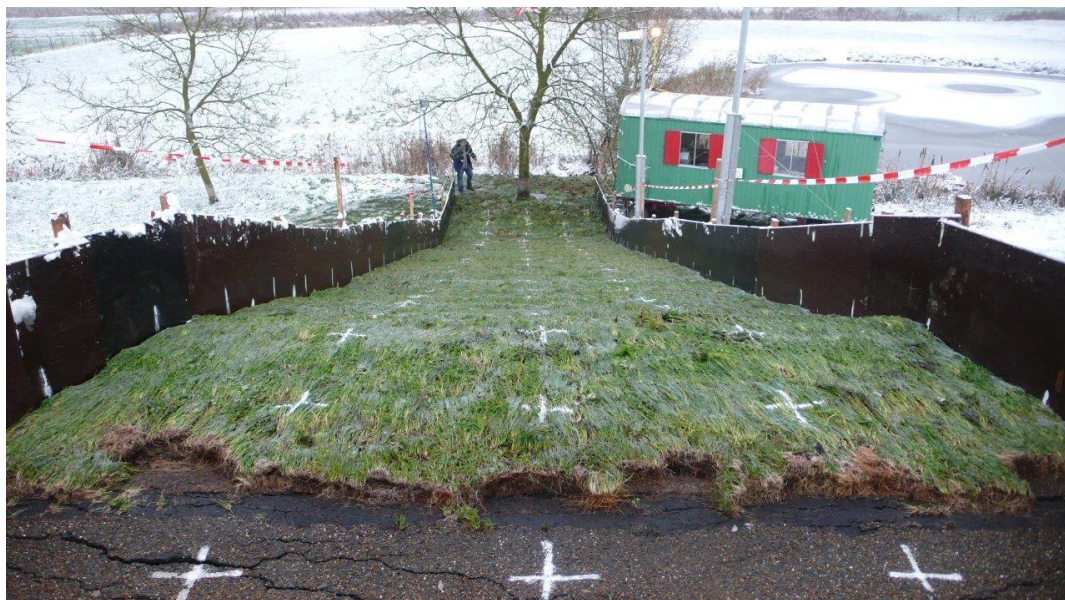
Figuur 4.6a. Tielrode, België. Durmedijk. Na eerste serie. Begin schade overgang asfaltkruin naar gras. Geen schade aan talud of boom.
