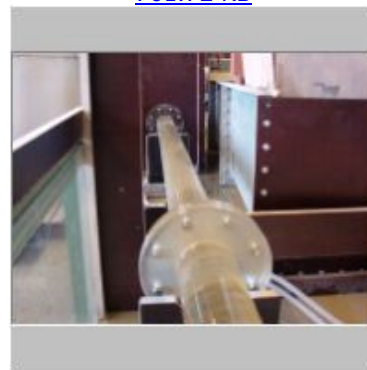
conduit connection outlet basin.jpg 258.29 KB
