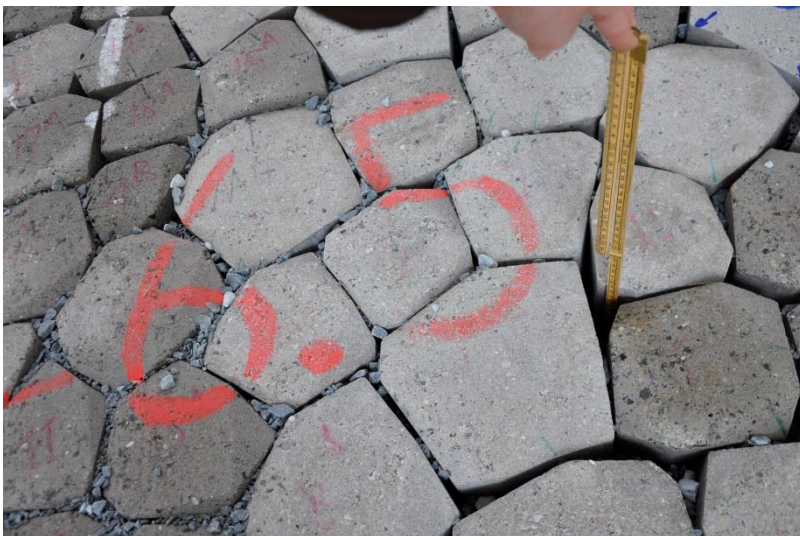
Figuur 4.3 Meting van de uitspoeldiepte in een spleet na proef B02. Er werd hier circa 19 cm gemeten, wat betekent dat het inwasmateriaal volledig uit de spleet is weggespoeld.
