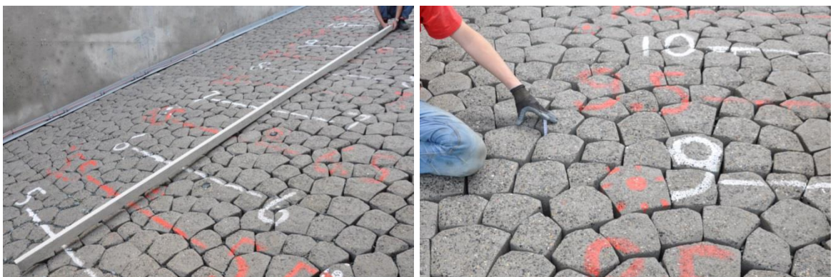
Figuur 4.12 Links: vervorming van het talud na proef B11. Rechts: meting van de uitspoeldiepte van het inwasmateriaal na proef B11. Op deze locatie is een diepte van circa 19,5 cm gemeten.
