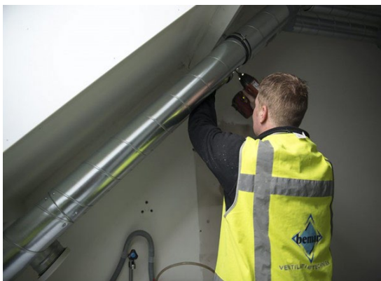
Figure 82. Woonwaard NOM renovation, piping
