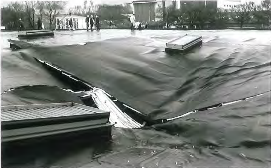
Figuur 15. Foto van ingestort Gammadak.
