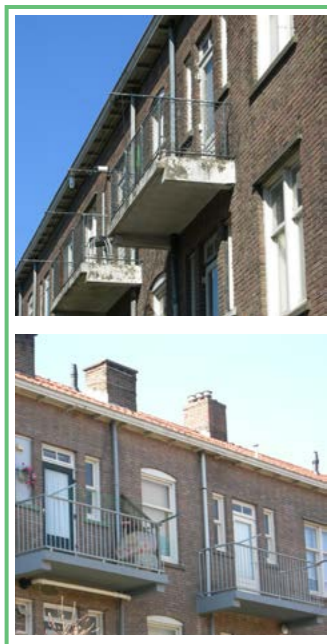
afbeelding auteur 4.29 verschil in balkons; wel en niet opgeknapt.
