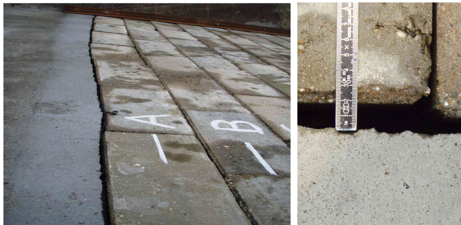
Figuur 11 Spleet aan bovenkant van bloklaag (links: na proef 16b, rechts: na proef 23)
