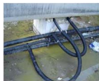
energiepaal aangesloten op de verdeelleidingen
