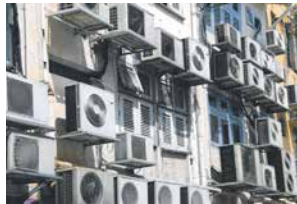
Airconditioners aan een gevel
