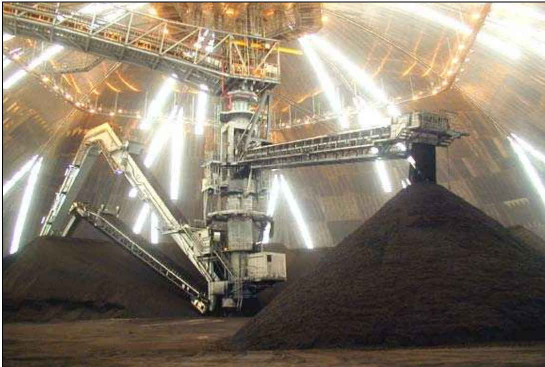
Figuur 3.2: circular stacker-reclaimer
