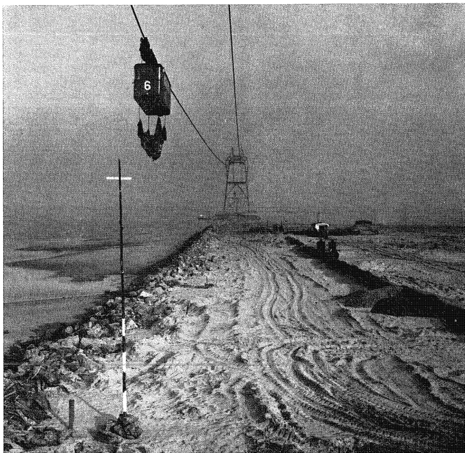
Opspuiten van het dijklichaam van de dam door de Noordelijke Geul van de Grevelingen
