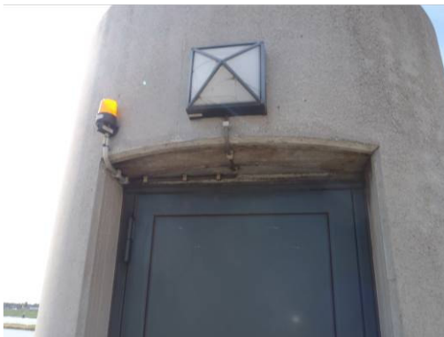
Fotonr. 119: Defect armatuur boven deur
