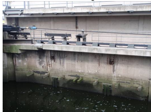
Fotonr. 155: chloride geïnitieerde schade
