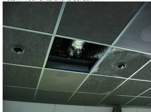
Fotonr. 192: Beschadigd luchtkanaal
