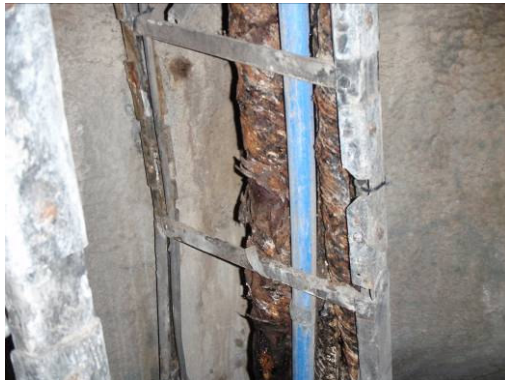
Fotonr. 106: gecorrodeerde kabels
