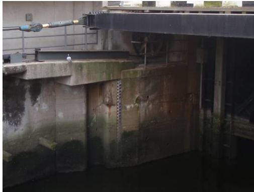
Fotonr. 152: scheuren en kalkuitbloei
