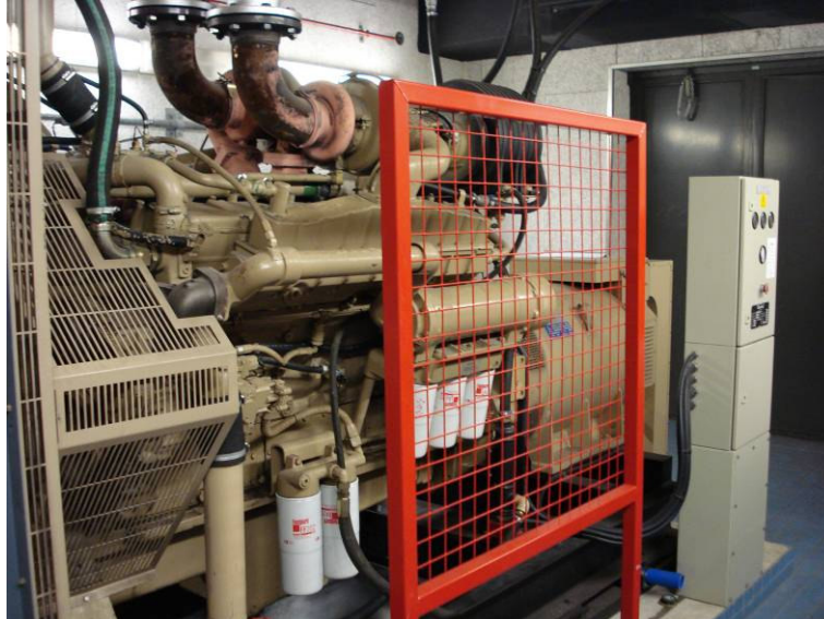
Fotonr. 116: Noodstroominstallatie, roterend
