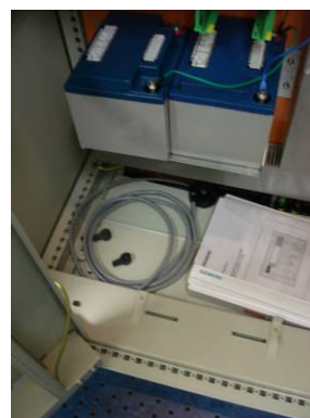
Fotonr. 61: losse kabel
