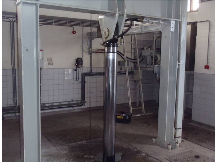
Fotonr. 18: Aandrijving- en bewegingswerk, rioolschuif
