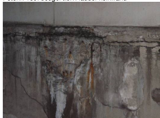
Fotonr. 161: scheuren met kalkuitbloei
