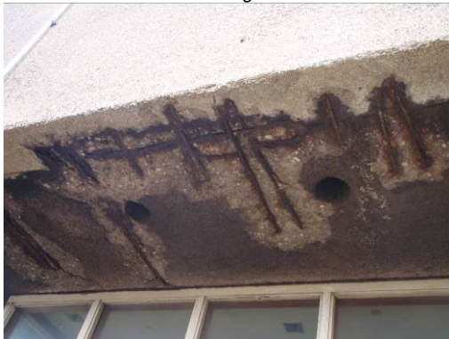
Fotonr. 79: Chloride schade gebouw schuiven
