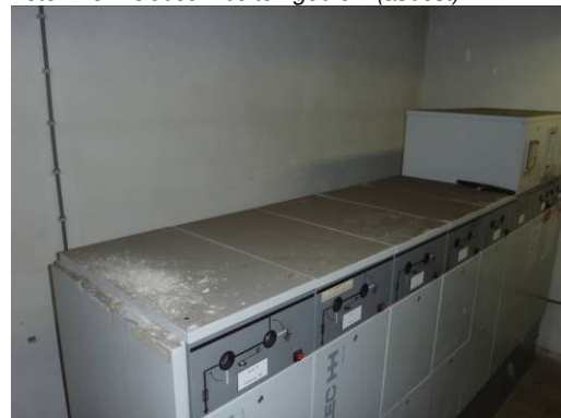
Fotonr. 86: Gebouw N3 lekkage op hoogspanning
