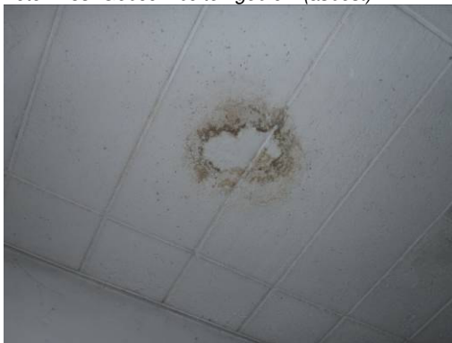
Fotonr. 85: Gebouw N3 lekkage
