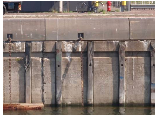
Fotonr. 166: mechanische schade en kalkuitbloei en scheuren
