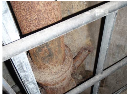
Fotonr. 107: gecorrodeerde leiding en bevestiging
