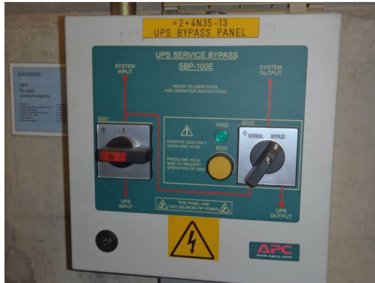
Fotonr. 117: Noodstroominstallatie, statisch
