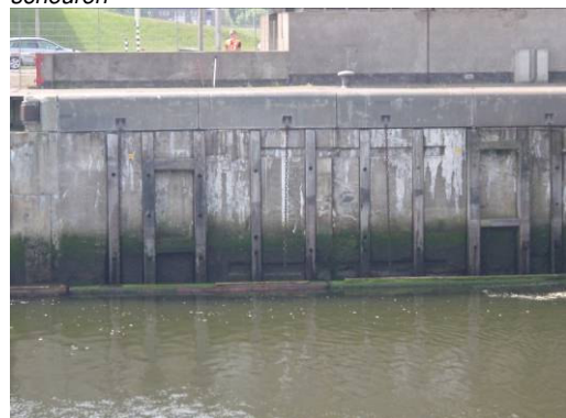
Fotonr. 168: mechanische schade en kalkuitbloei en scheuren
