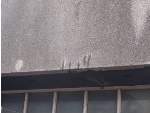
Fotonr. 77: Chloride schade gebouw schuiven
