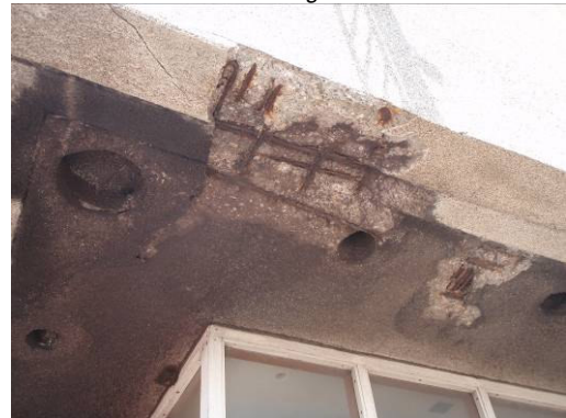
Fotonr. 80: Chloride schade gebouw schuiven
