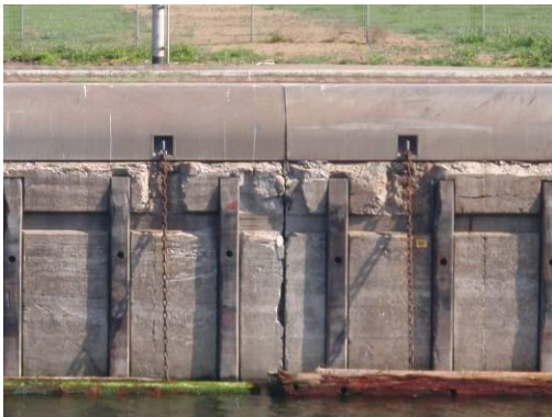
Fotonr. 165: mechanische schade en kalkuitbloei en scheuren
