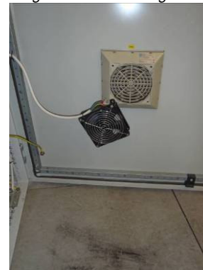
Fotonr. 49: Ventilator hangt los, rooster is vuil
