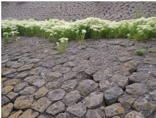
Fotonr. 121: voegvulling ontbreekt gedeeltelijk
