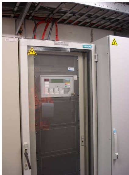
Fotonr. 58: Brandmeld- en ontruimingsinstallatie
