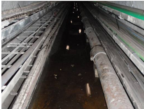
Fotonr. 104: water in kelder onder sluishoofd
