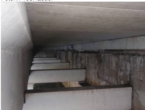
Fotonr. 160: scheuren met kalkuitbloei
