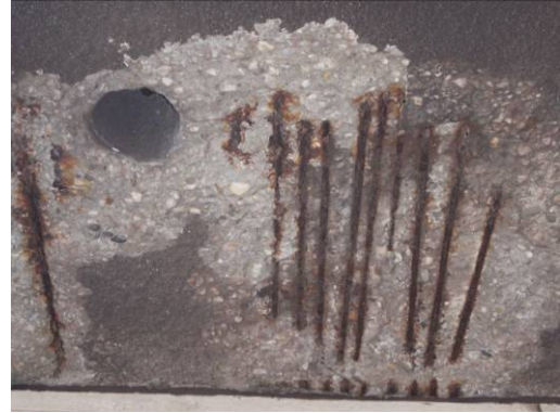
Fotonr. 78: Chloride schade gebouw schuiven
