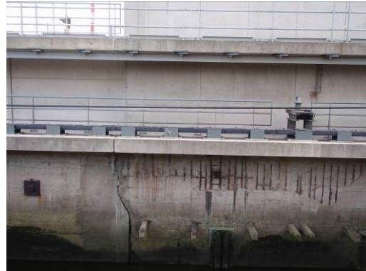
Fotonr. 153: scheur en chloride geïnitieerde schade
