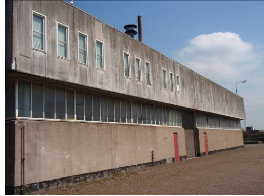
Fotonr. 84: Gebouw buiten gebruik (asbest)
