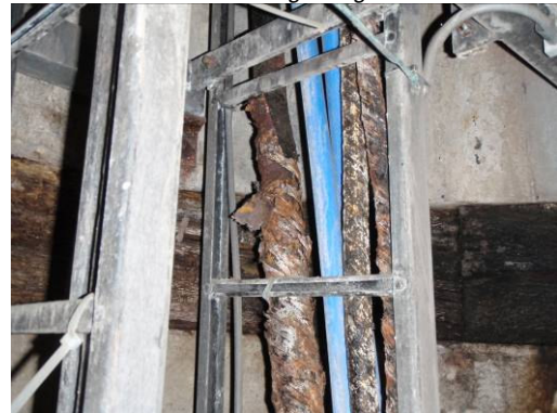
Fotonr. 105: gecorrodeerde kabels
