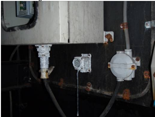
Fotonr. 147: contactdoos is gecorrodeerd en niet afgedekt
