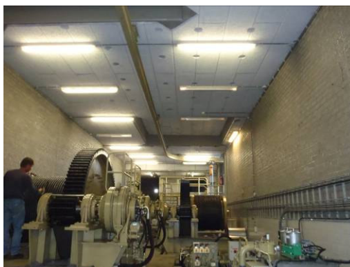
Fotonr. 51: Defecte binnenverlichting
