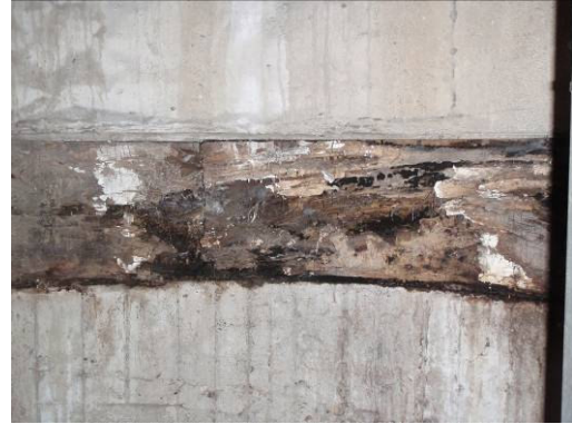
Fotonr. 103: rot hout in voegvulling
