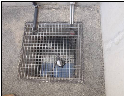
Fotonr. 132: Onbeschermde kabeldoorvoer
