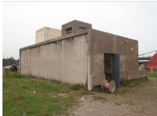
Fotonr. 74:: Gebouw N3 hoogspanning
