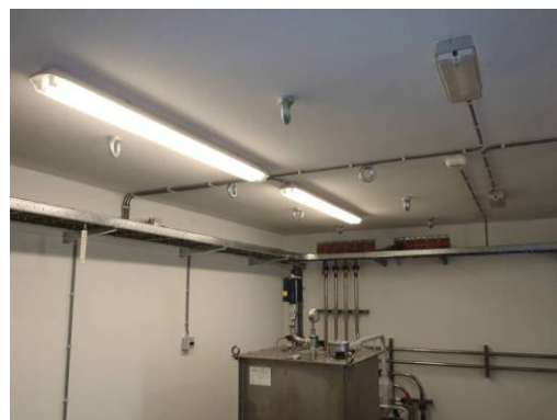
Fotonr. 52: Defecte binnenverlichting
