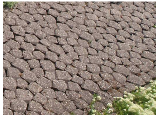
Fotonr. 122: voegvulling ontbreekt gedeeltelijk
