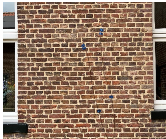
Figuur 4: Oppervlaktetemperatuursensoren aan de buitenzijde van de gevel.
