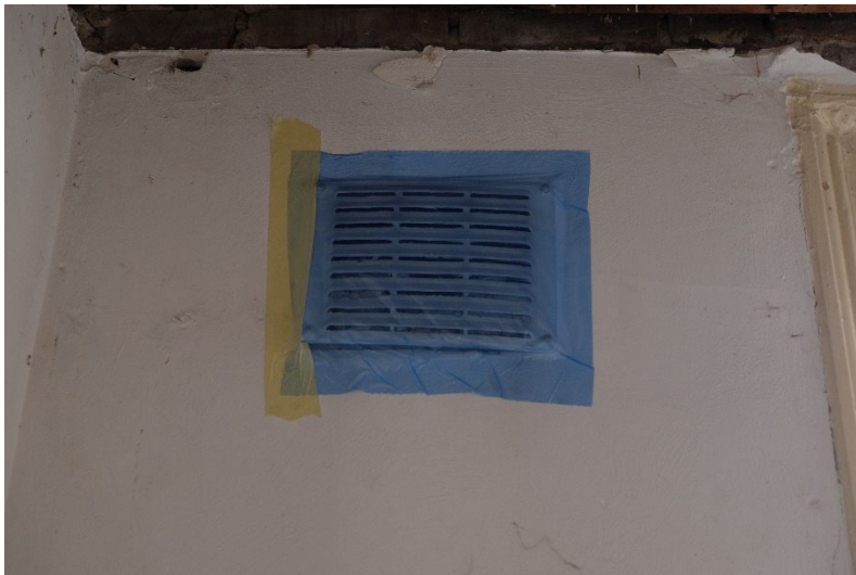
Figuur 7: Afplakken luchtlekken rondom gevelrooster.
