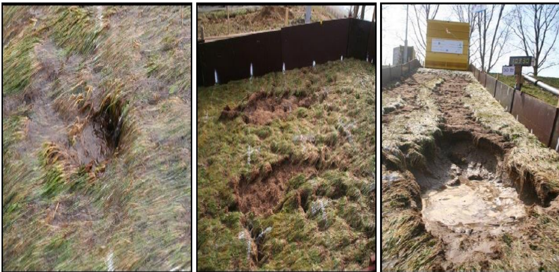
Figuur 2.1 Initiële schade, Schade op meerdere locaties en Falen van dijk; Schade en falen op het binnentalud als gevolg van golfoverslag
