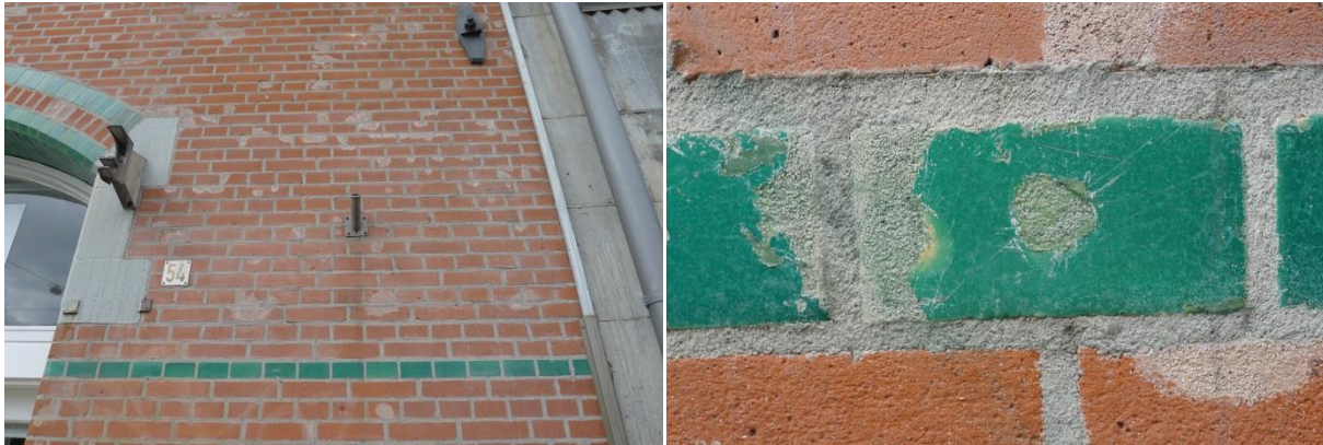
Baksteen met mortelreparaties
