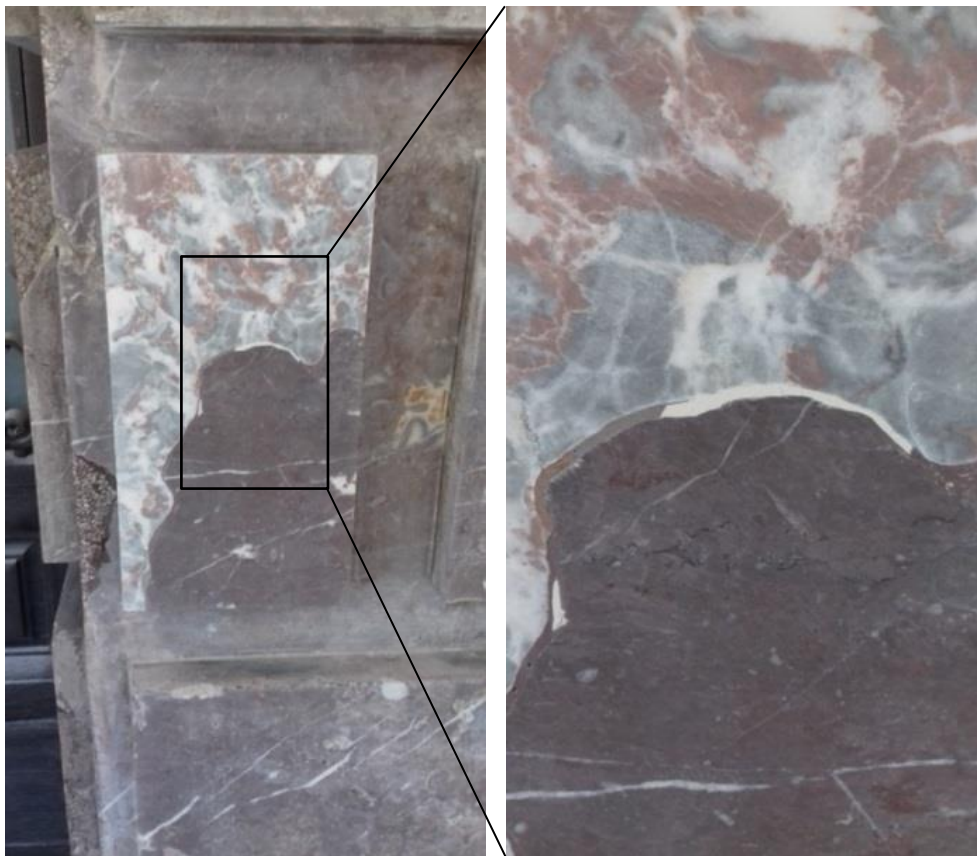
Fig. 11: Steenprothese met epoxy lijmmaad. De marmerkeuze van de steenprothese integreert niet met de donkerrode tint van het te herstellen rood marmer
