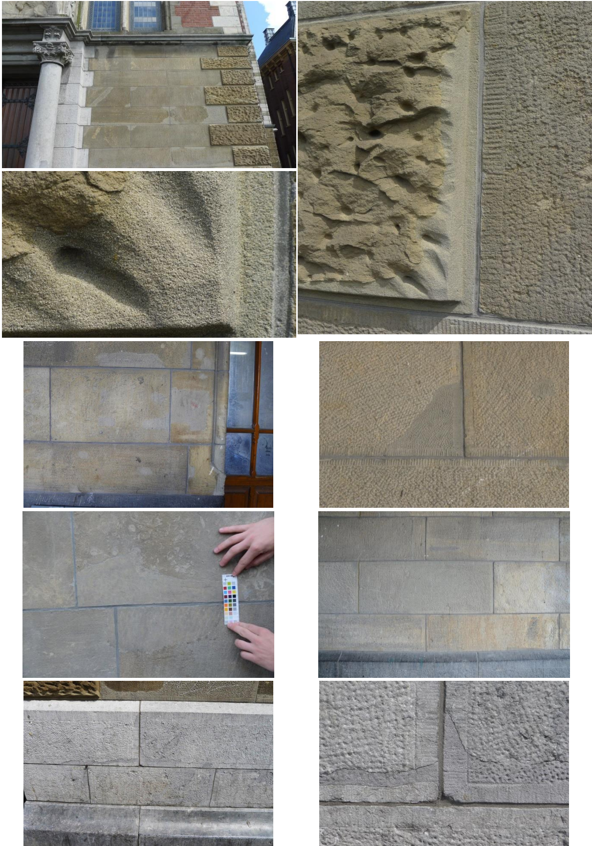
Plint van blauwe hardsteen met mortelreparaties
