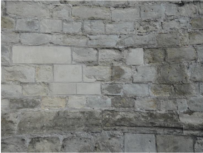
Fig. 11: Oppervlakteherstel Monulit natuursteen-Reparatiemortel. Door de vlakken volledig te vullen is men doorgeschoten in de toepassing van reparatiemortel. Het Monulit oppervlak vertoont na 20 jaar nog geen vertering
