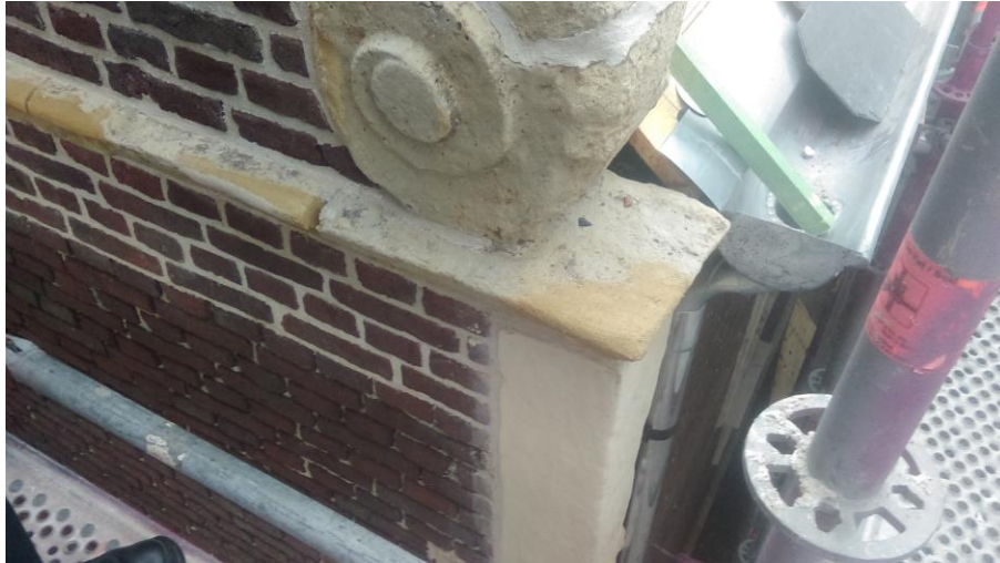
Fig. 8: Onderste lijst na restauratie met zinkoxide steenherstelmortel (mortel dient nog opgeschuurd te worden om het juiste kleur te bekomen)
