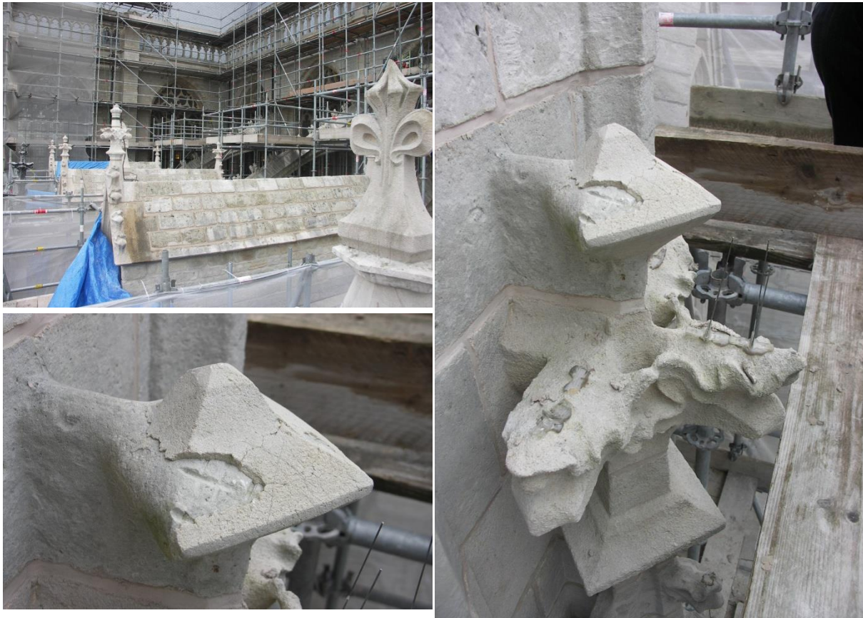
Fig. 22: Natuurstenen elementen met mortelreparaties van de grote kerk in Breda
