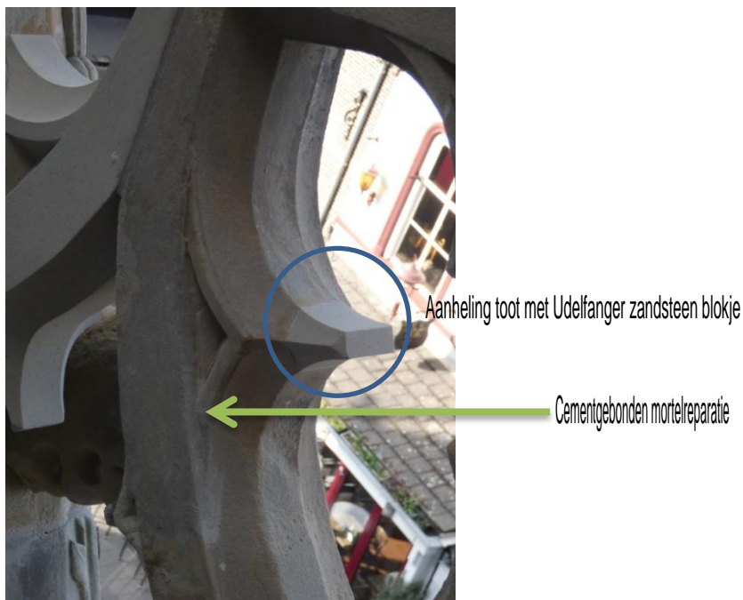
Fig. 4: Cementgebonden reparatie van balustrade element (periode 1970-1980) vanwege goede kwaliteit besloten tot handhaving. De visuele dissonant van de mortelreparatie werd geaccepteerd omdat deze zich aan de gootzijde van de balustrade bevindt
