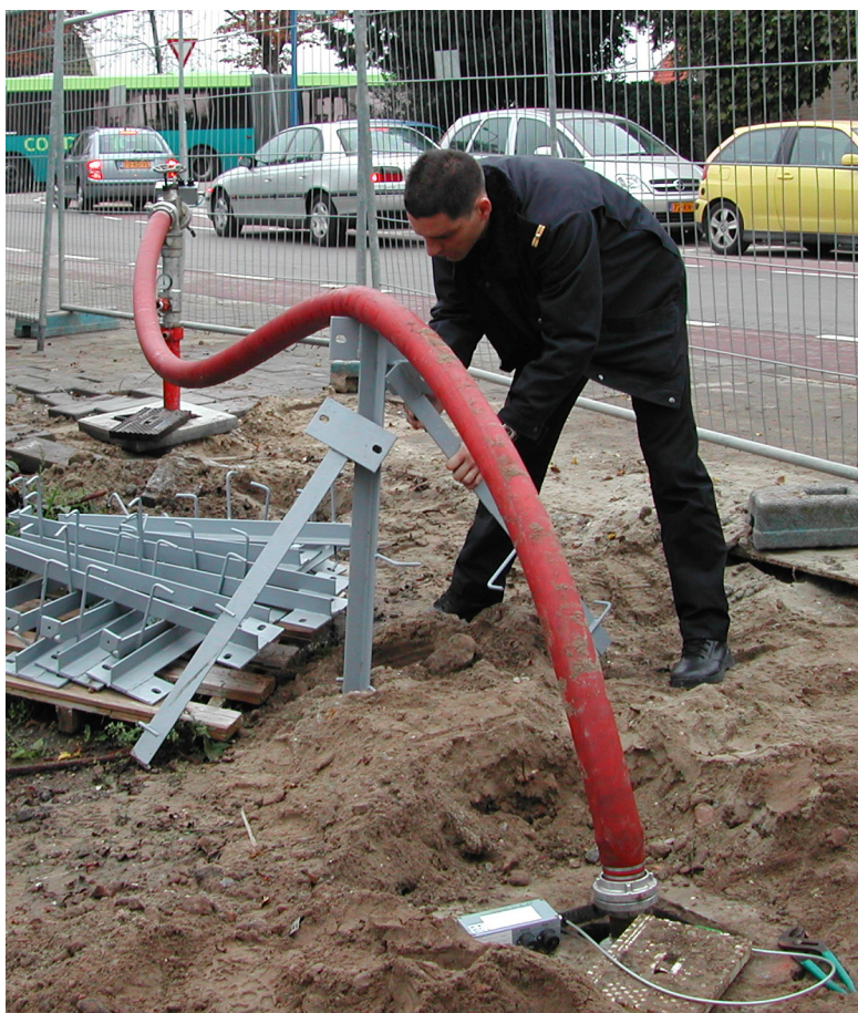
Figuur 4.2 Tijdelijke verbinding tussen de brandkraan op het distributienet en de droge bluswaterleiding (foto Kiwa Water Research)
