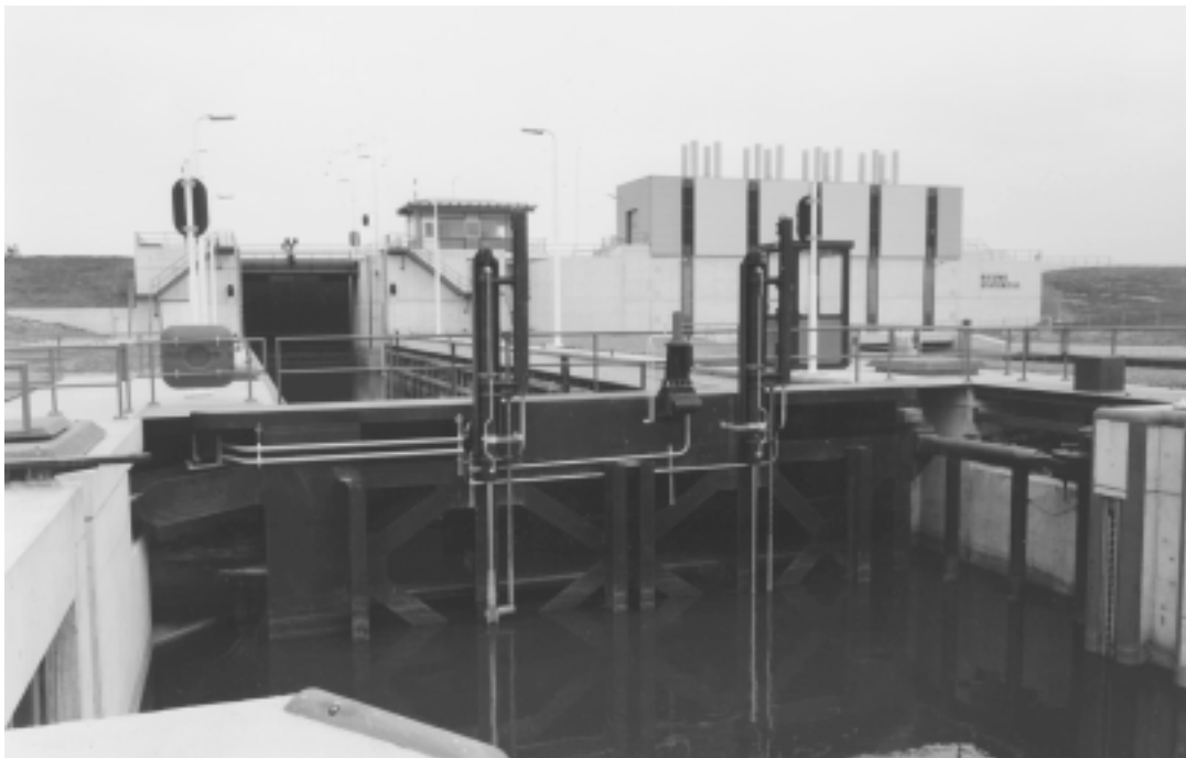
Foto 7.33 Hydraulische cilinder schuifbewegingswerk van enkele draaideur van schutsluis te Nieuwe Statenzijl
