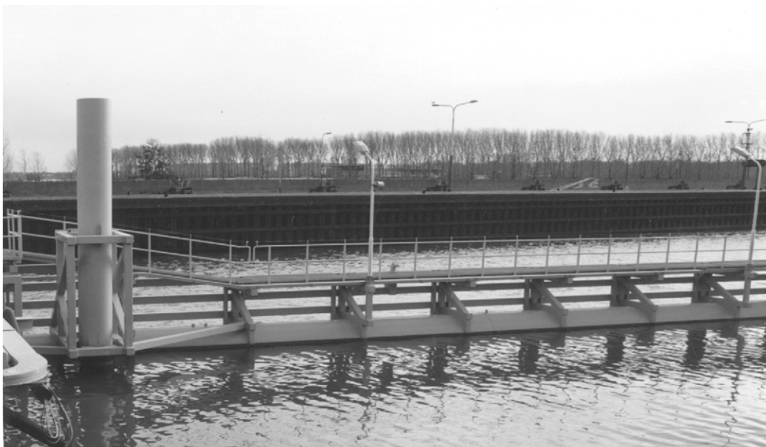
Foto 15.12 Paalraam met drijvende buisligger van geleidewerken van sluizen te Heel
