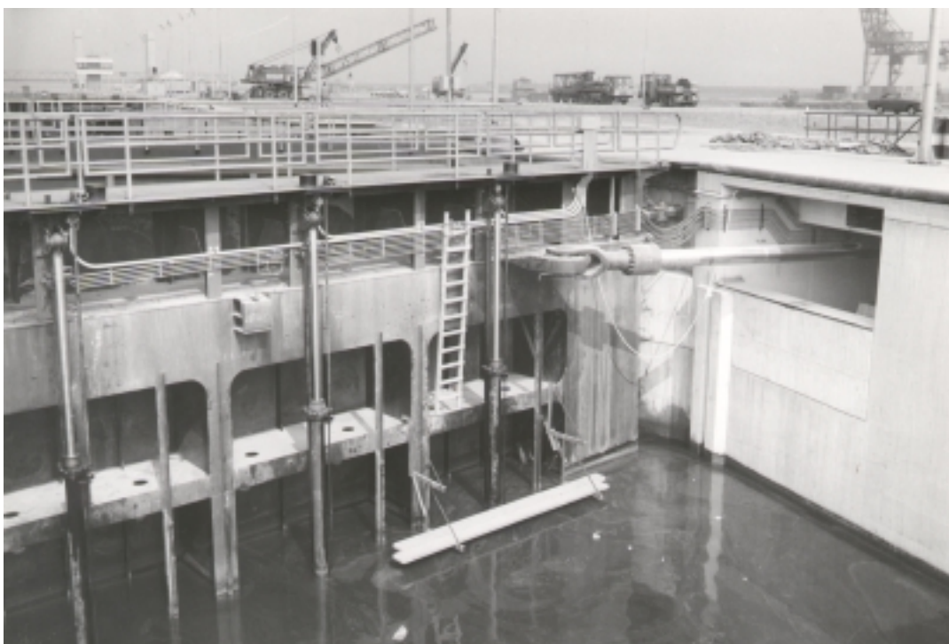
Foto 7.17 Hydraulische cilinder aandrijving van puntdeuren en schuiven van Rozenburgse sluis
