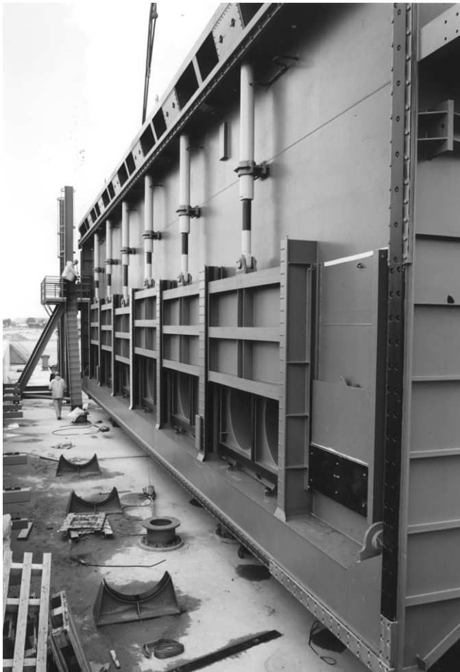
Foto 6.12 Schuiven voor de ronde openingen van de glijdeur van Nieuwe Oranjesluis te Amsterdam
