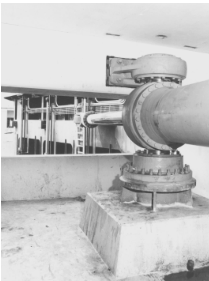
Foto 7.18 Hydraulische cilinder deurbewegingswerk van Rozenburgse sluis
