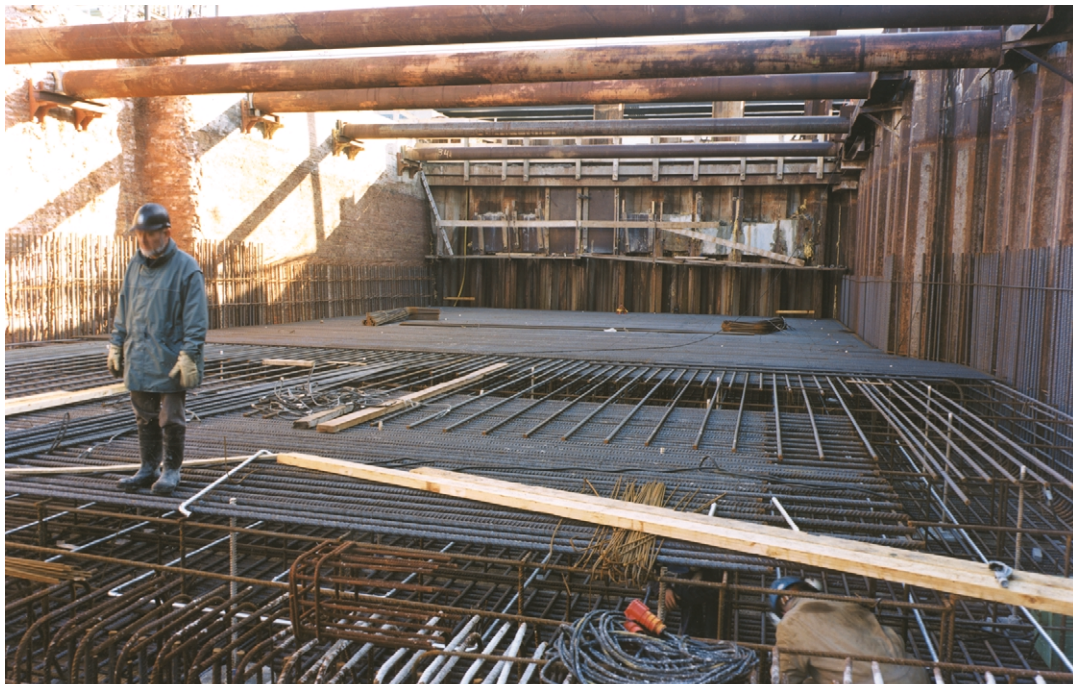
Foto 23.4 Vloerwapening binnenhoofd Kleine Sluis
