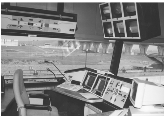
Foto 18.4 Opstelling bedieningssysteem, Krammersluizen
