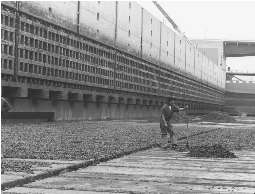
Foto 21.11 Drooggezette kolk tijdens het verwijderen van mosselaangroei, Krammer duwvaartsluizen
