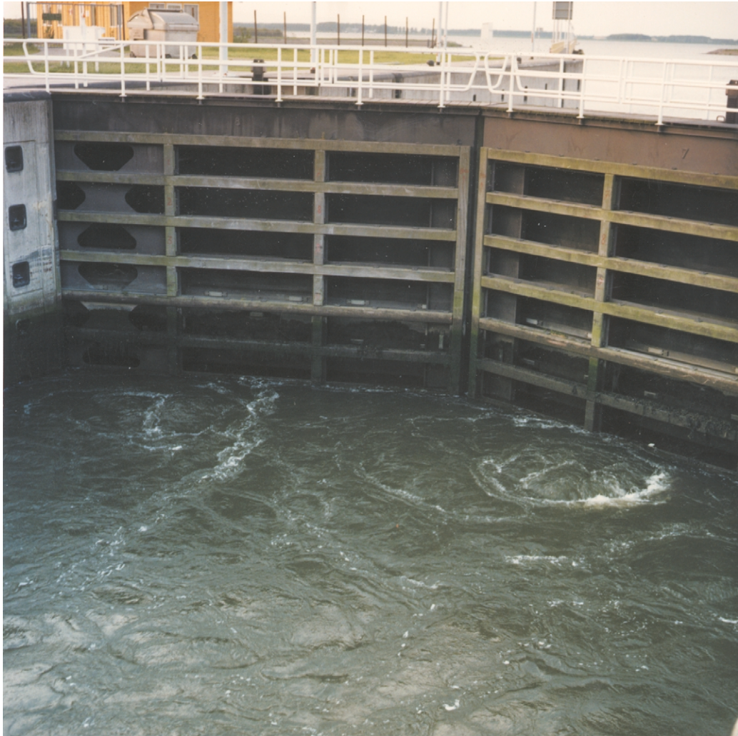
Foto 6.1 Stroombeeld tijdens vullen van jachtensluis in de Volkerak
