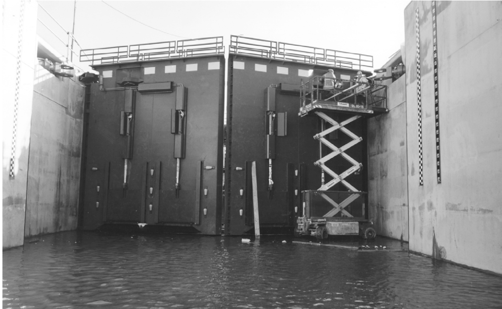
Foto 6.10 Deurschuiven voor de rechthoekige openingen van de puntdeuren van Kleine Sluis te IJmuiden
