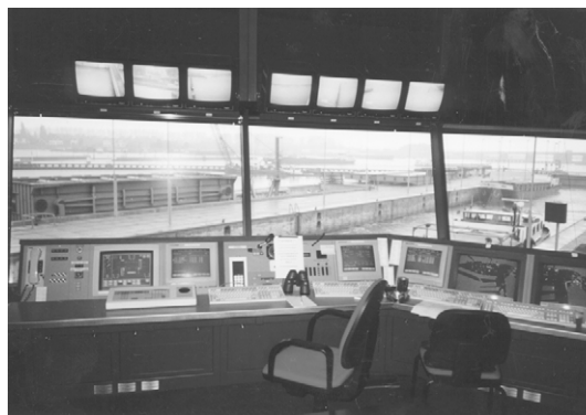
Foto 18.13 Bedieningslessenaar, Prins Willem-Alexandersluis (Monitors van o.a. CCTV, bediening sluis, IVS, radar en Knoppenpanelen van praatpaal/luidspreker/marifoon)
