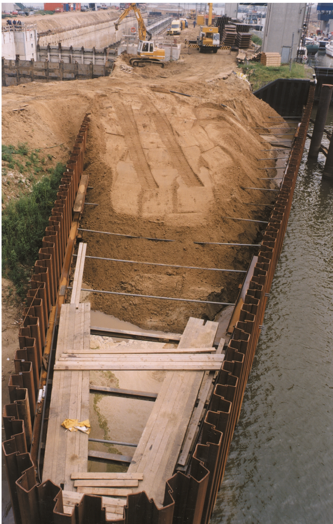
Foto 14.1 Kistdam als beëindiging middeneiland van sluiscomplex
