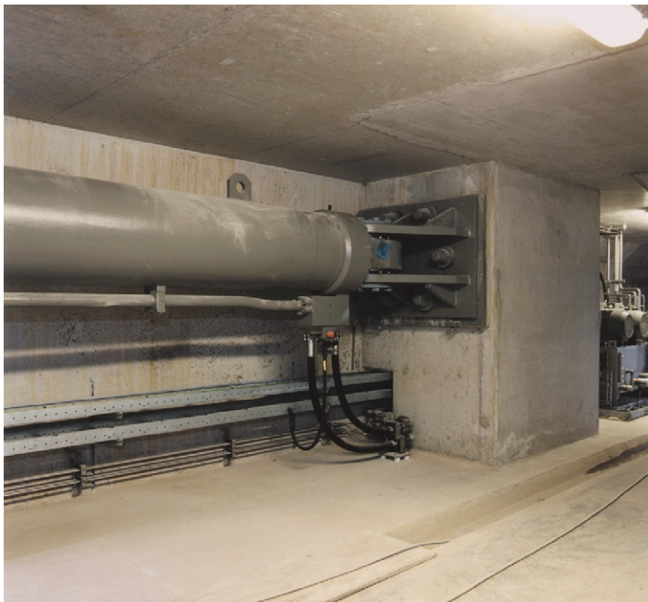
Foto 23.27 Hydraulische cilinder deurbewegingswerk
