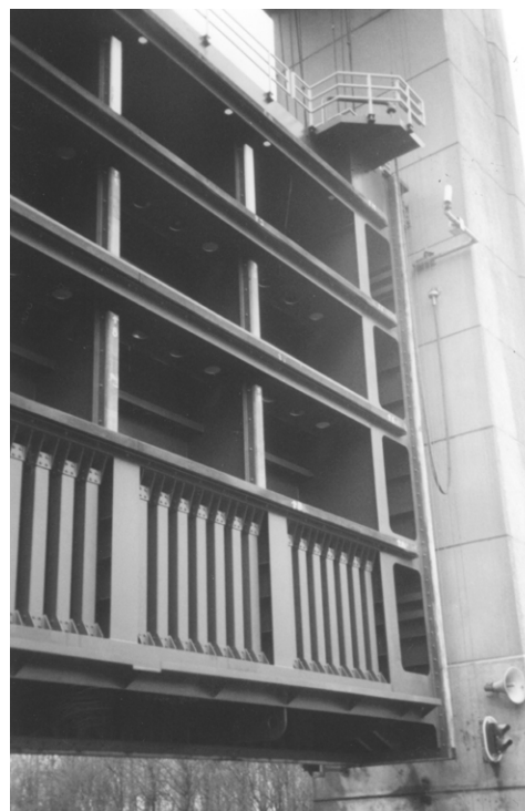
Foto 6.9 Breekbalken achter rechthoekige openingen in de hefdeur van nieuwe sluis te Weurt
