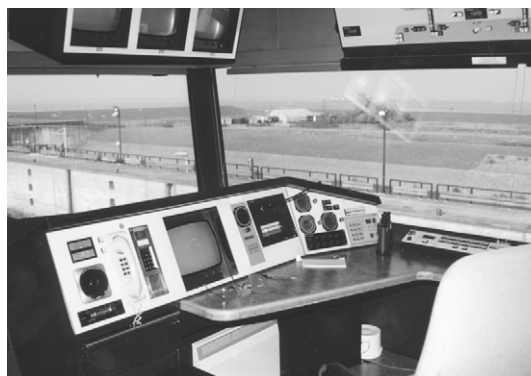
Foto 18.5 Opstelling bedieningssysteem, Krammersluizen
