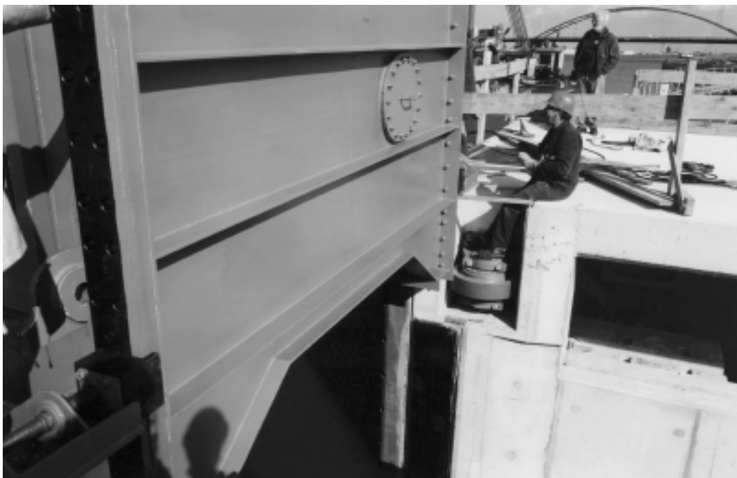
Foto 7.30 Horizontaal geleidewiel van glijdeur van Nieuwe Oranjesluis te Amsterdam
