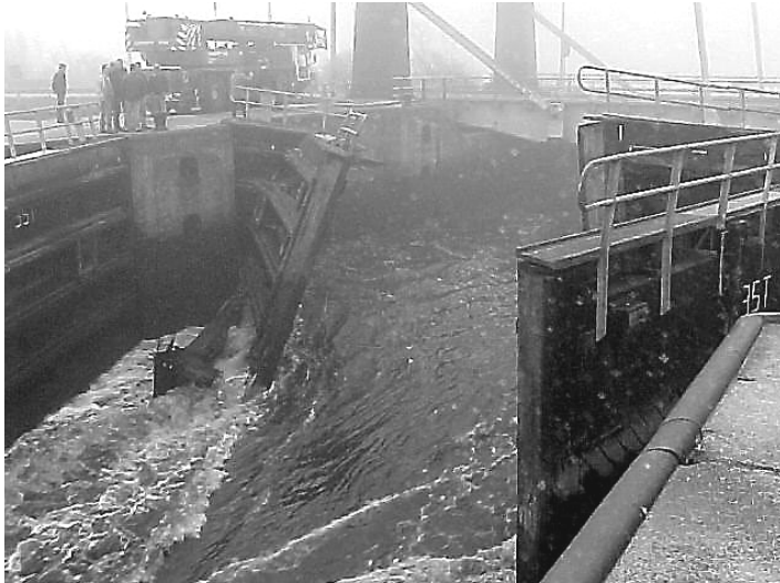
Foto 11.8 De bezweken ebdeuren van het binnenhoofd van de sluis te Farnsum met stroming vanuit het Eemskanaal
