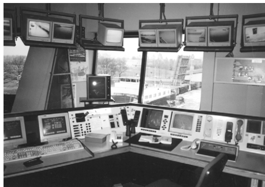
Foto 18.9 Bedieningslessenaar, Middensluis Terneuzen
