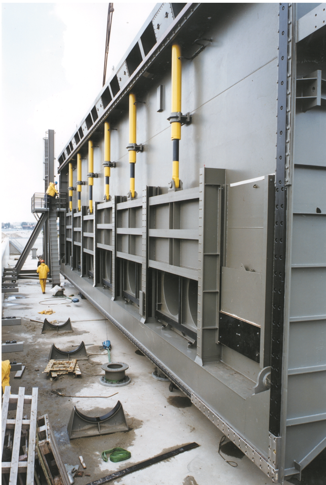
Foto 12.1 Glijdeur van de Nieuwe Oranjesluis met aanzicht van de ronde vulopeningen en schuiven met schuifbewegingswerken
