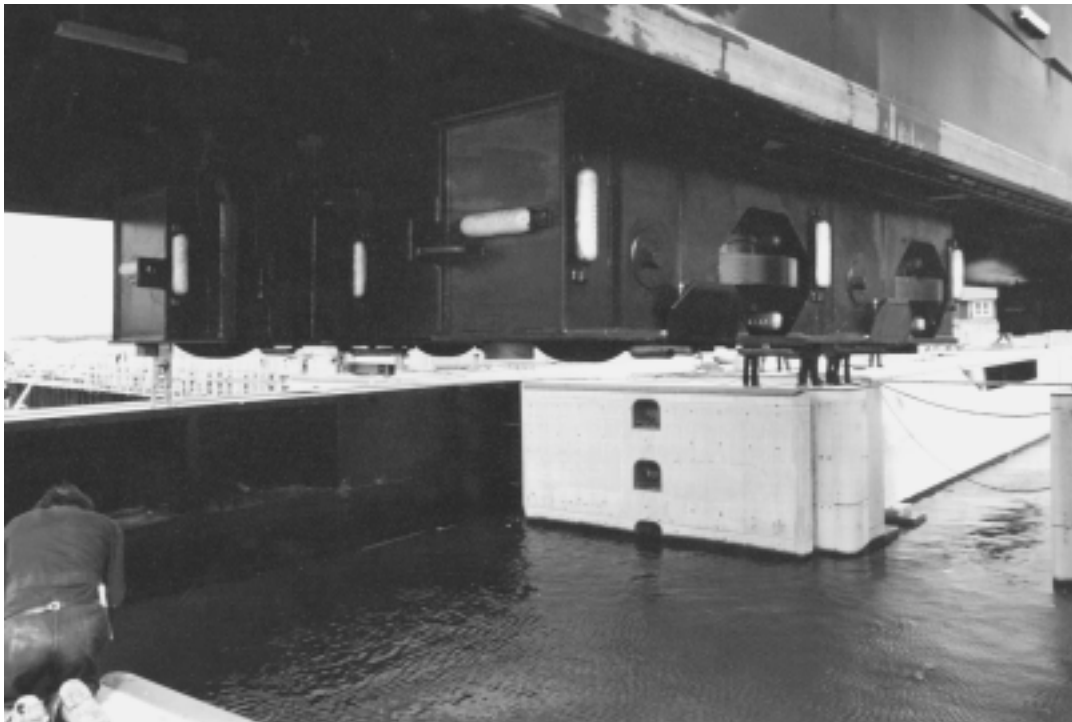
Foto 7.27 Onderrolwagen van roldeur van Middensluis te Terneuzen
