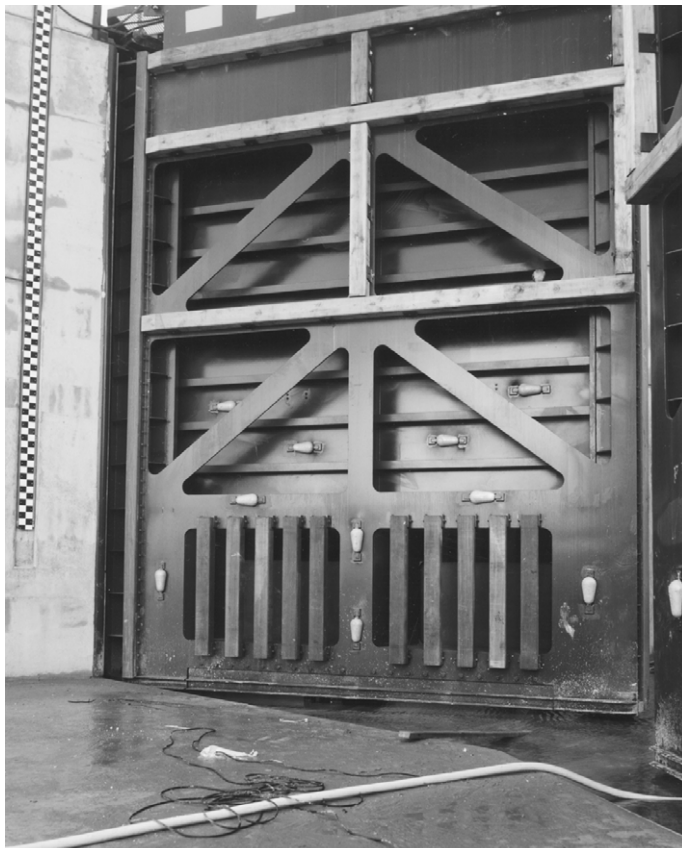
Foto 6.11 Breekbalken achter de rechthoekige openingen van de puntdeuren van Kleine Sluis te IJmuiden
