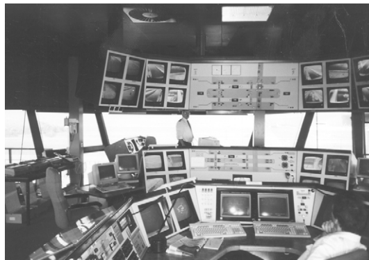
Foto 18.3 Opstelling bedieningssysteem, Krammersluizen
