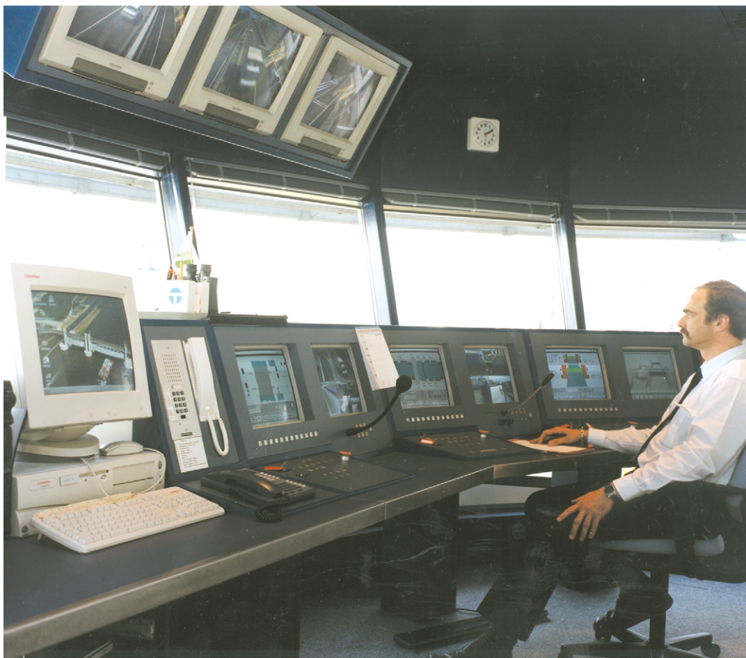
Foto 18.1 Bedieningsruimte van de schutsluis naast de stormvloedkering van Krimpen aan de IJssel (Zie ook foto 17.9)
