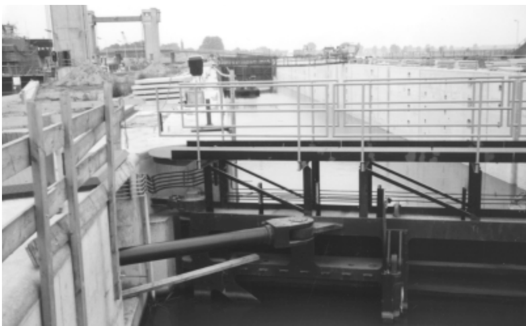
Foto 7.20 Hydraulische cilinder deurbewegingswerk van Tweede Sluis te Lith
