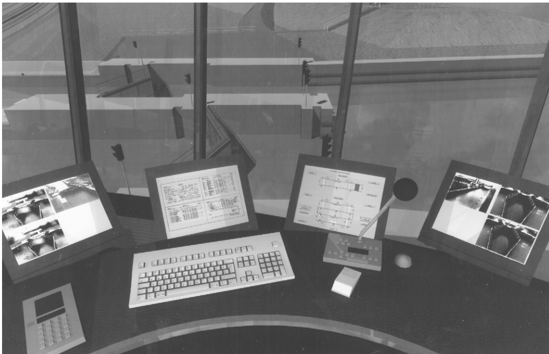
Figuur 18.11 Werkplek voor bediening Naviduct Krabbersgatsluizen te Enkhuizen.
