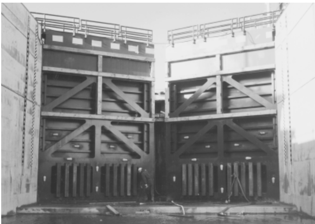
Foto 7.3 Stalen puntdeuren van Kleine Sluis te IJmuiden (1999)
