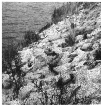
10 Monoliet oeverbeschermingsconstructie langs de rivier 'De Nete' in België, kort na aanleg
