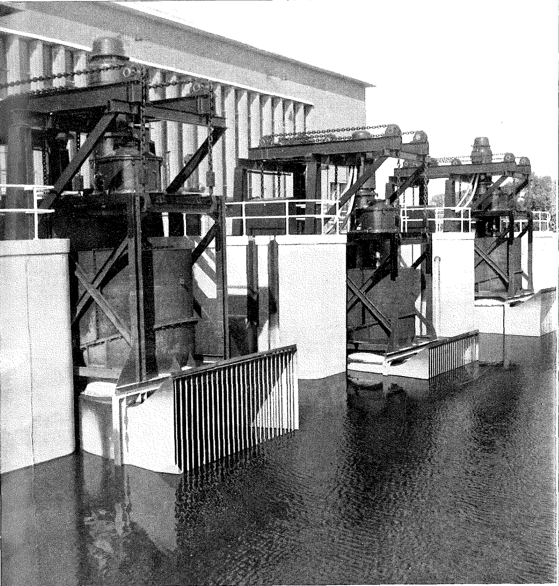
Afb. 3 De inlaatpompen van het gemaal „Pijnacker Hordijk” van het Hoogheemraadschap „Rijnland” te Gouda, in opgetrokken stand. Met dit gemaal kan zowel natuurlijk water worden ingelaten of gespuid als kunstmatig water worden ingepompt of uitgemalen.
