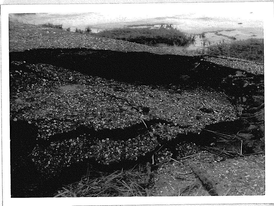
5 UITSPOELING BIJ DOORBRAAK (DETAIL VAN FOTO No. 4)
