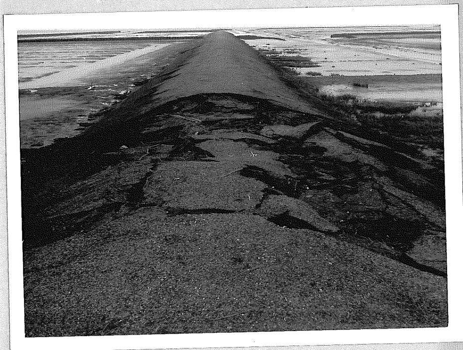
4 DOORBRAAK GEZIEN IN NOORDELIJKE RICHTING; SCHADE AAN WESTELIJK TALUD
