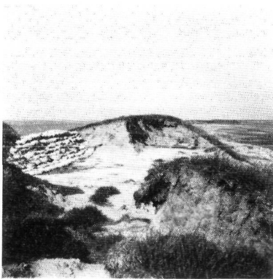
← fig. 86. Oud Noord-Beveland- polder. Dijksbeschadiging bij dijkpaal 26.
