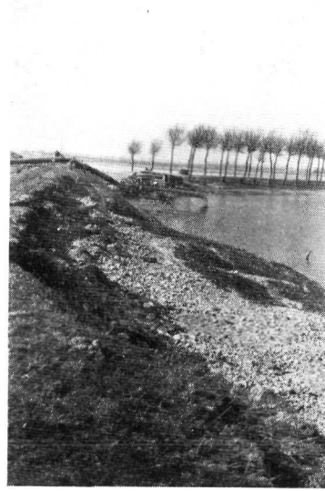
fig. 84. Jonkvrouw Anna- polder. Afschuiving binnentalud bij dijk- paal 38. (Pompinstallatie pompt de polder leeg)
