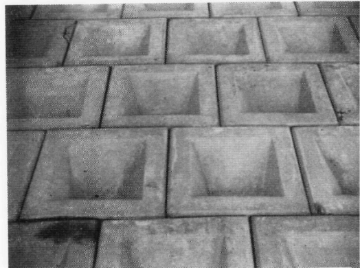
fig. 133. Betonblokkenglooïing (systeem Haringman) aan de Zandkreekdam.
